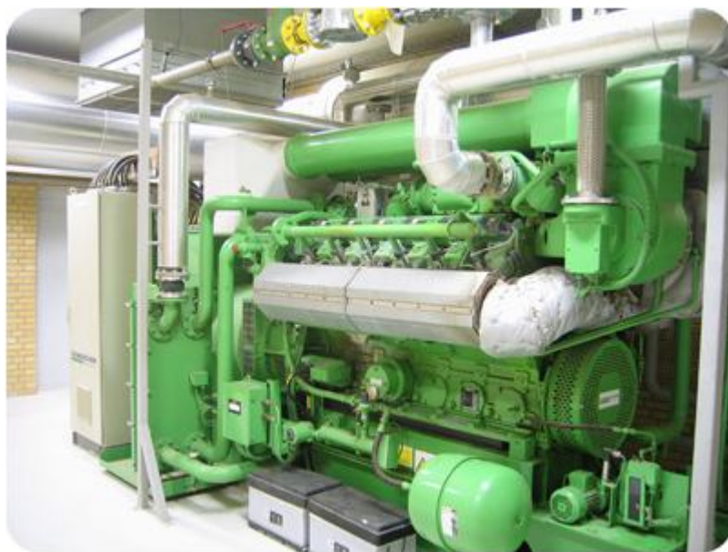
Σχήμα 4.5: Μονάδα Συμπαραγωγής Ηλεκτρικής και Θερμικής Ενέργειας [25]
