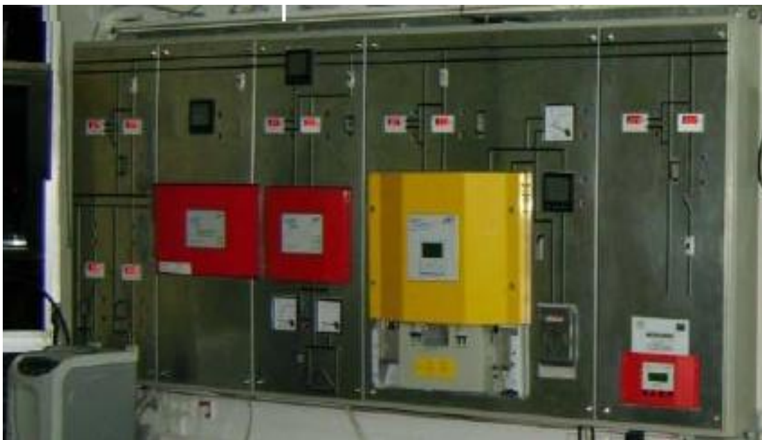
Σχήμα 1.2 Φωτογραφία του μικροδικτύου του εργαστηρίου Συστημάτων Ηλεκτρικής Ενέργειας
