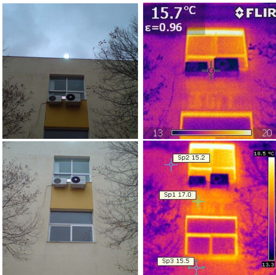
Εικόνα 4.5: Εμφάνιση υγρασίας ανάμεσα σε 2 ορόφους
