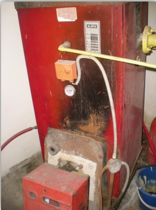
Εικόνα 4.7 Το σύστημα λέβητα καυστήρα του κτιρίου (Elinox ELS-80)
