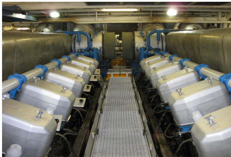
Σχήμα 4 - διάδρομος συντήρησης και εποπτείας μεταξύ των δύο από τις τέσσερις προωστήριες μηχανές τύπου Wartsila
