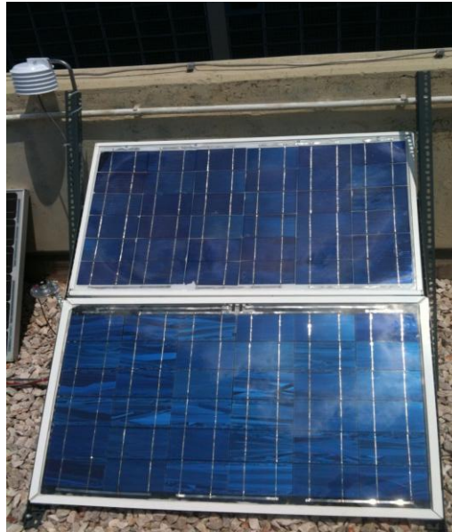
Σχήμα 4.6. Φωτοβολταικά πλαίσια πολυκρυσταλλικού πυριτίου στην οροφή του κτιρίου των Ηλεκτρολόγων
