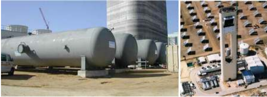
Σχήμα 2.20 Οι δεξαμενές αποθήκευσης πεπιεσμένου ατμού του ηλιοθερμικού σταθμού PS10. [59]
