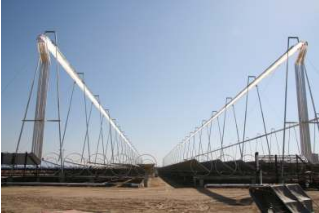
Σχήμα 2.16 Ο ηλιοθερμικός σταθμός τεχνολογίας CLFR Kimberlina Solar Thermal Energy Plant. [50]
