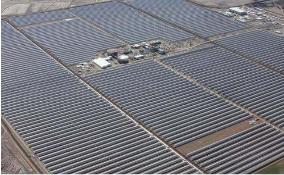
Σχήμα 3.1 Γενική άποψη του ηλιοθερμικού σταθμού παραβολικών κατόπτρων Andasol 1. [64]
