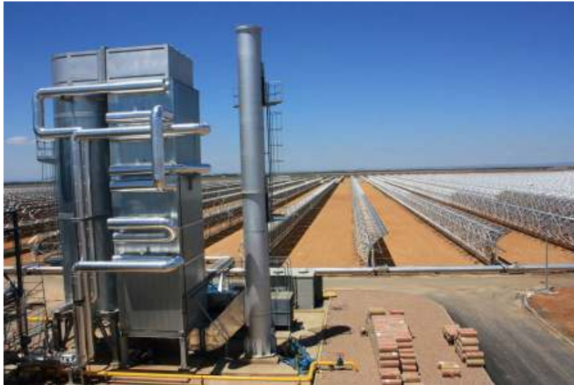
Σχήμα 4.8 Βοηθητικός λέβητας θέρμανσης του μέσου μεταφοράς της θερμότητας για ηλιοθερμικούς σταθμούς ηλεκτροπαραγωγής της εταιρείας SUGIMAT. [91]
