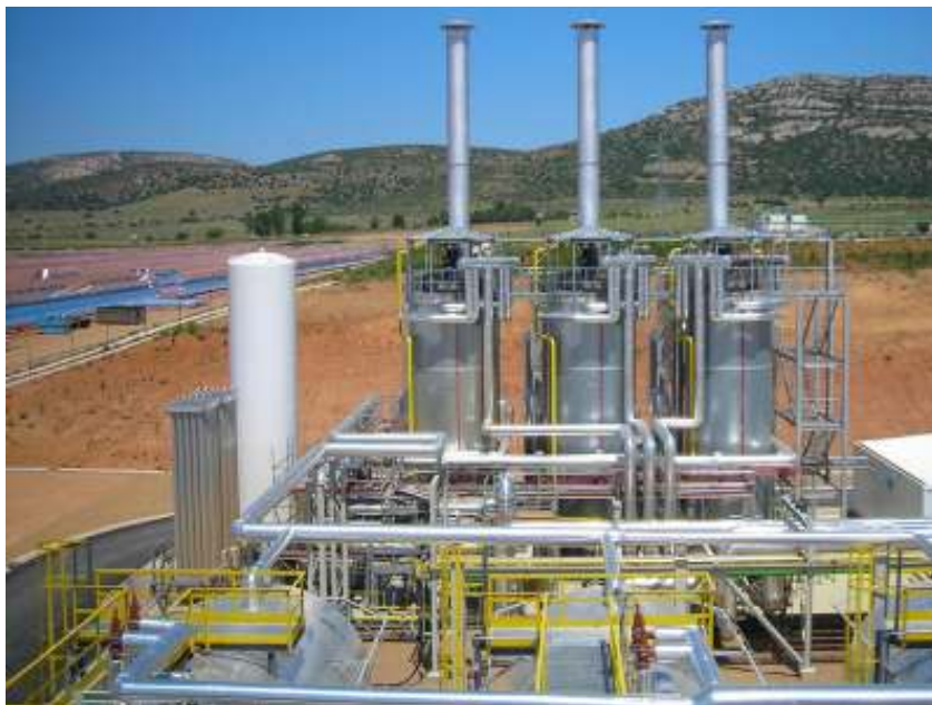
Σχήμα 3.21 Βοηθητικός λέβητας θέρμανσης του μέσου μεταφοράς της θερμότητας για ηλιοθερμικούς σταθμούς ηλεκτροπαραγωγής της εταιρείας SUGIMAT. [91]
