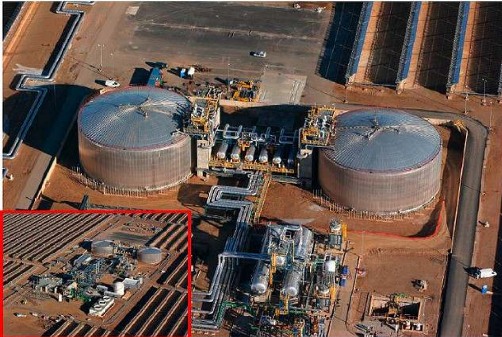
Σχήμα 2.17 Το σύστημα αποθήκευσης θερμότητας δύο δεξαμενών του Andasol. Στην ένθετη φωτογραφία φαίνεται η θέση του συστήματος αποθήκευσης στον ηλιοθερμικό σταθμό. [58]
