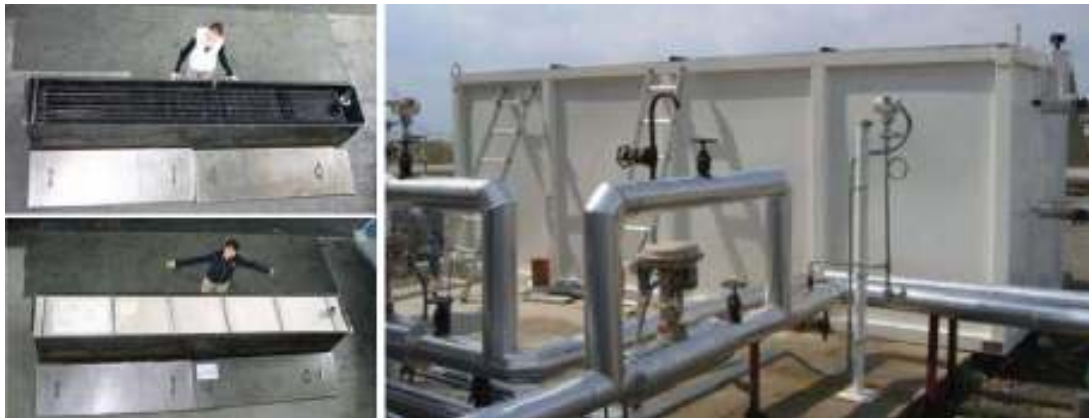
Σχήμα 2.21 Πειραματικός σταθμός με δυνατότητα αποθήκευσης 200kWh σε PCMs στο γερμανικό κέντρο ερευνών DLR. [59]
