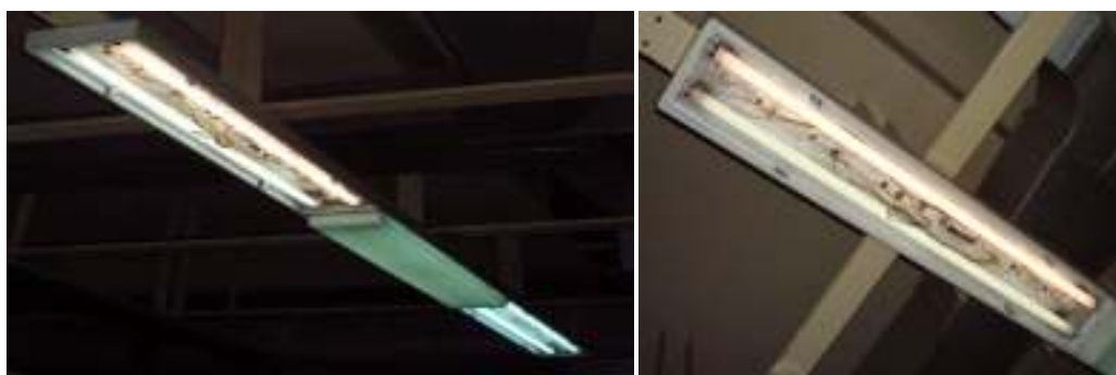
Σχήμα 4.15 : Φωτιστικά σώματα στα οποία έχει αφαιρεθεί το διαχυτικό κάλυμμα είτε από τους χρήστες, είτε λόγω καταστροφής του
