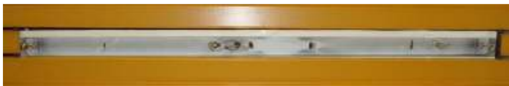
Σχήμα 4.17 : Κατεστραμμένο φωτιστικό σώμα
