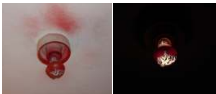
Σχήμα 4.19 : Φωτιστικό σώμα οροφής με βαμμένο λαμπτήρα
