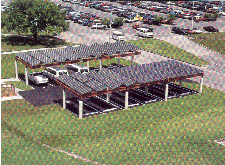
Εικόνα 50: Υπόστεγο στάθμευσης αυτοκινήτων EV με 20 kW από πλέγμα Φ/Β για τη φόρτιση EV που βρίσκεται στο Πανεπιστήμιο της Νότιας Florida (1991)
