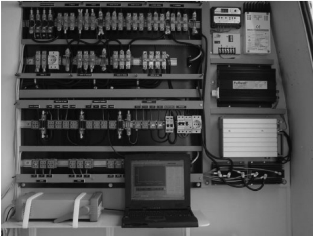
Εικόνα 6: Πίνακας σύνδεσης εγκατεστημένος μέσα στο πρωτότυπο
