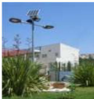
Εικόνα 5. 3-1: Αυτόνομο φωτιστικό με φωτοβολταϊκό πλαίσιο.
