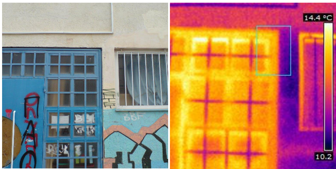
Εικόνα 4.11 Θερμογέφυρα ανάμεσα σε σιδερένια πόρτα και τείχο έξω από αίθουσα
