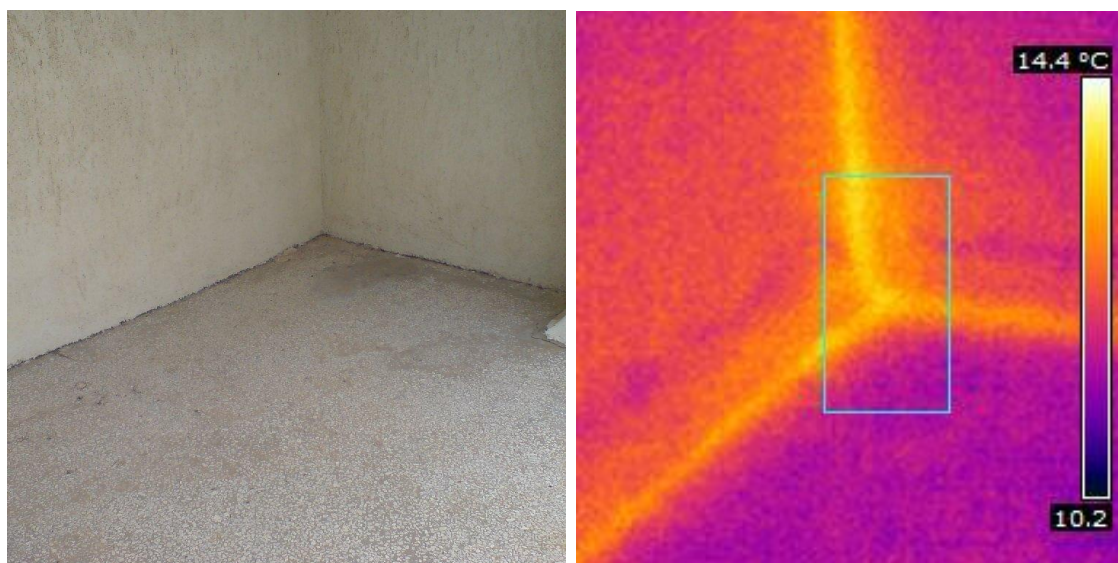
Εικόνα 4.1 Εκροή αέρα από τον τοίχο
