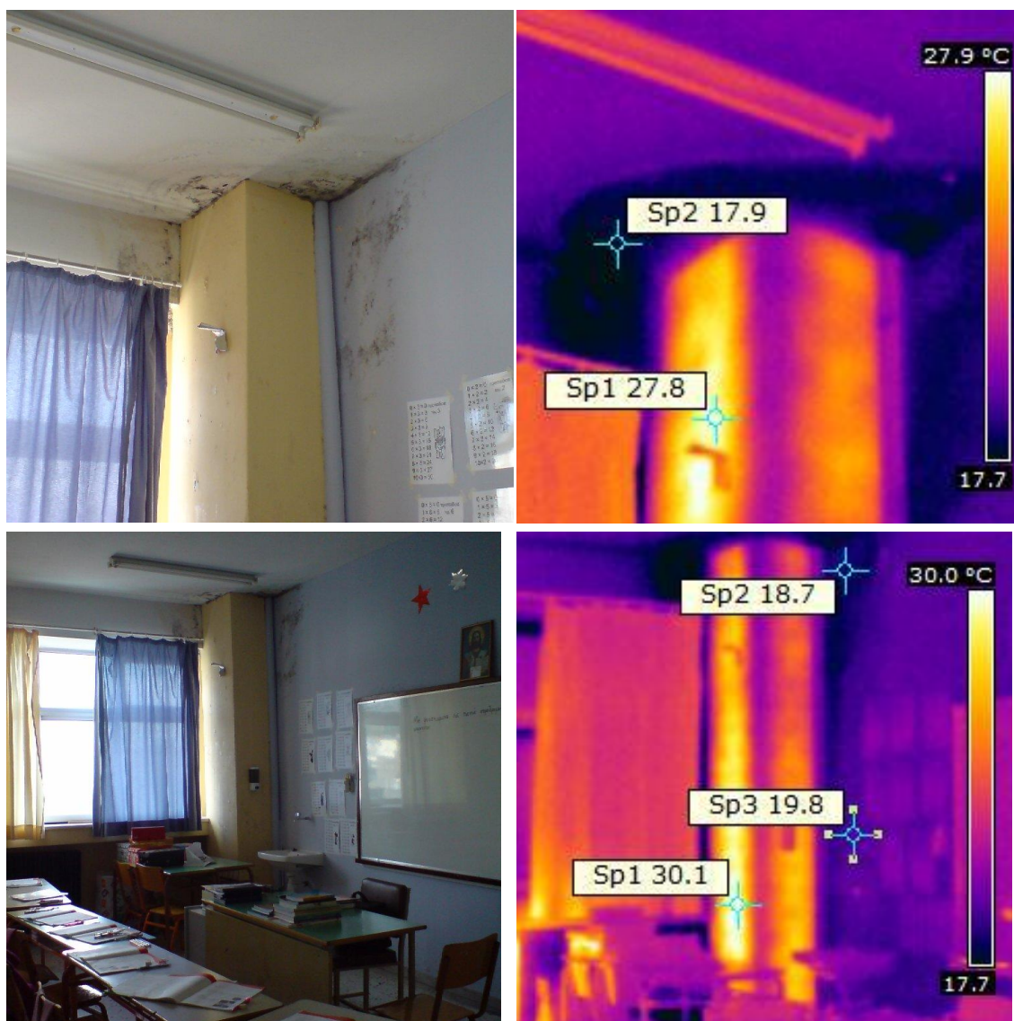
Εικόνα 4.3 Προβλήματα υγρασίας γύρω από κολώνες που περιέχει σωλήνα συστήματος θέρμανσης
