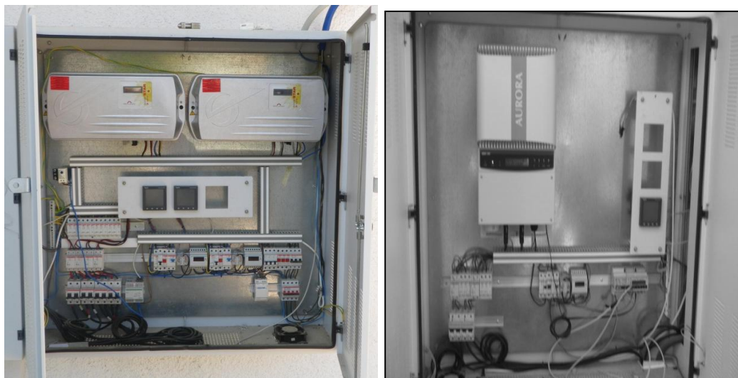
Εικόνες 3.10 και 3.11 – Ηλεκτρολογικός πίνακας
