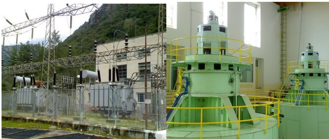
Υδροηλεκτρικό Εργοστάσιο Λάδωνα
