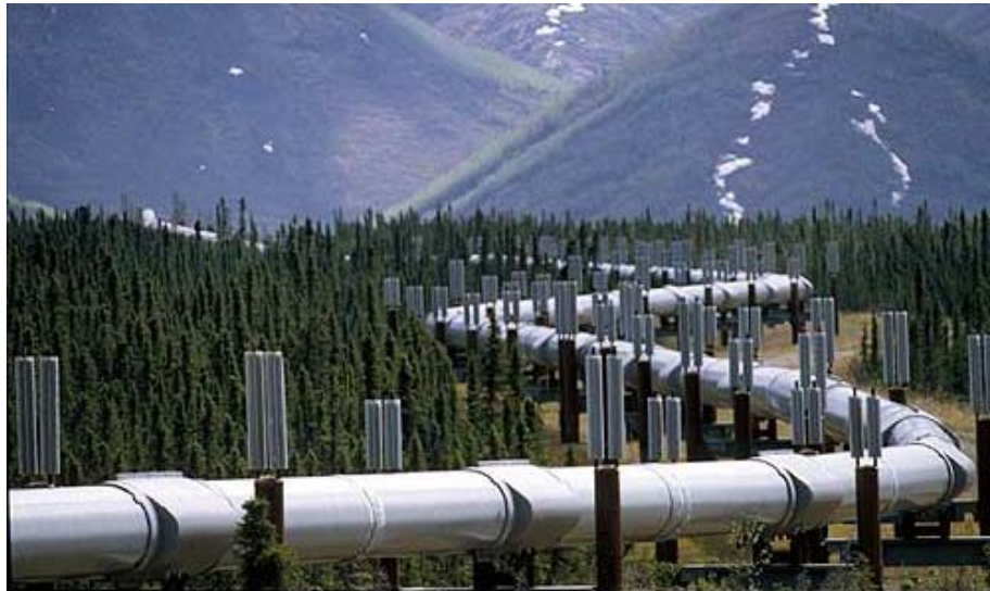
Σχήμα 4.3: Αγωγός μεταφοράς ΦΑ
