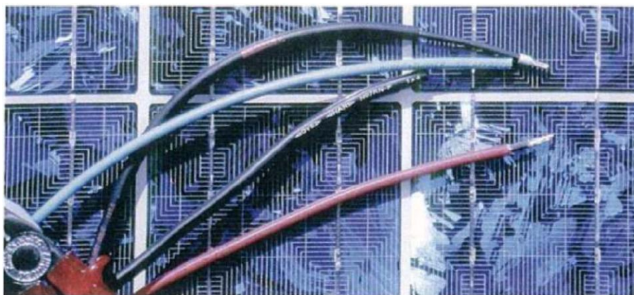
Εικόνα 4.27: Τυπικά καλώδια φωτοβολταϊκών πλαισίων
