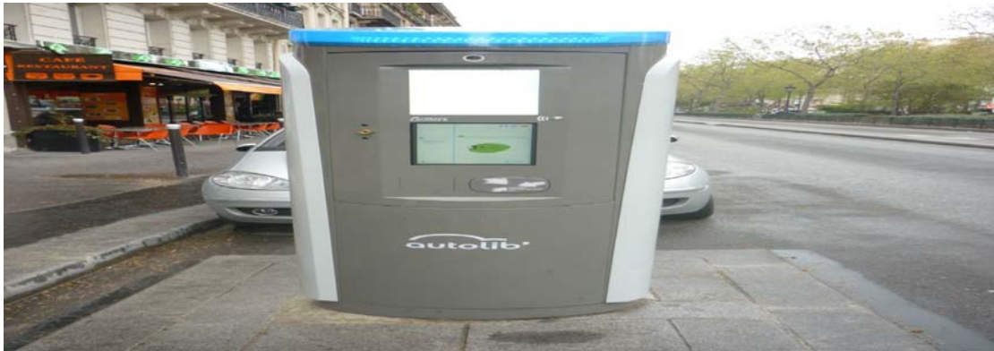
Εικόνα 17: σταθμός ενσύρματης φόρτισης στο Παρίσι
