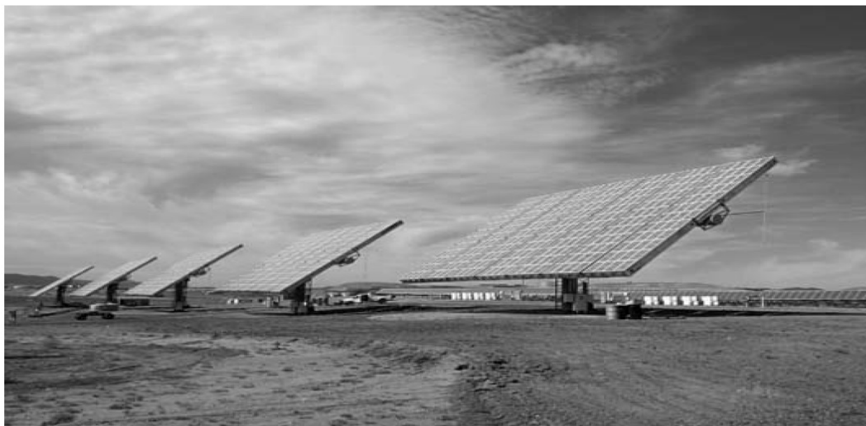
Εικ. 4.1. Πέντε HCPV συστήματα των 35 kW εγχύουν απευθείας ηλεκτρικό ρεύμα στο ηλεκτρικό δίκτυο της Αριζόνας
