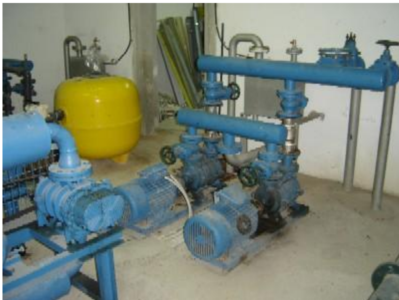
Εικόνα 5.14 Τυπική εγκατάσταση αντλιοστασίου μεσαίας ονομαστικής ισχύος
