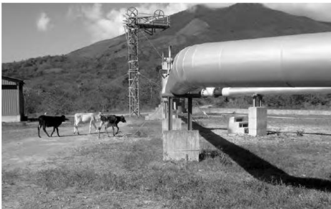
Εικόνα 1.4 Σωληνώσεις του γεωθερμικού σταθμού παραγωγής Miravalles, Κόστα Ρίκα [2]
