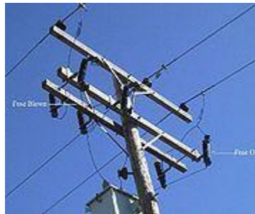
Εικόνα 11: Υποσταθμός υψηλής τάσης
