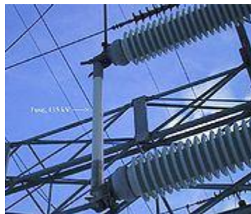
Εικόνα 12: Ασφάλεια υψηλής τάσης στον υποσταθμό (μεγέθυνση)
