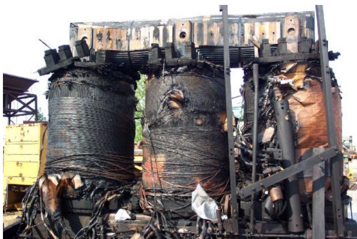
Σχ. 5.6 Μετασχηματιστής λαδιού έπειτα από έκρηξη που προηγήθηκε από αστοχία στο εσωτερικό του
