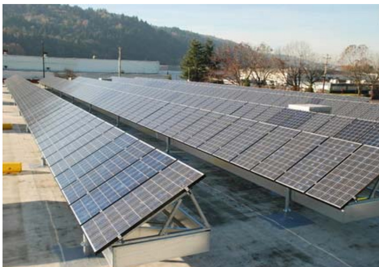
Σχήμα 5. 11: συστοιχία διασυνδεδεμένων φωτοβολταϊκών στοιχείων σε οροφή
