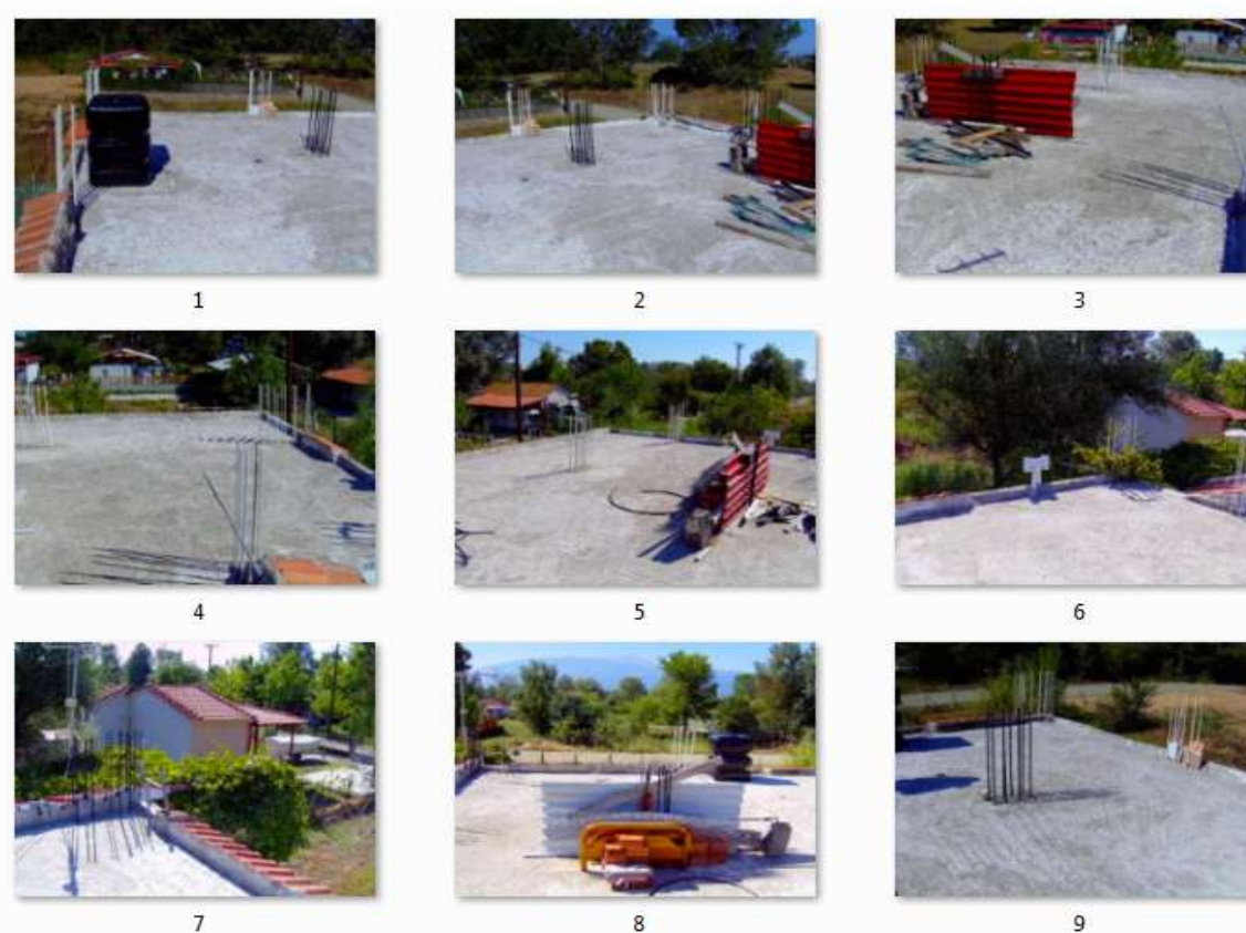
Εικόνα 4.2 «Περιμετρική Άποψη του Χώρου Εγκατάστασης - Ιούλιος 2012»
