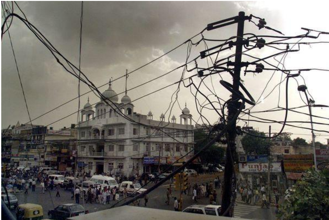
Σχήμα 3.7 Νέο Δελχί 2002, ένα κουβάρι καλωδίων σε πυλώνα του ηλεκτρικού δικτύου σε πολυσύχναστο δρόμο.
