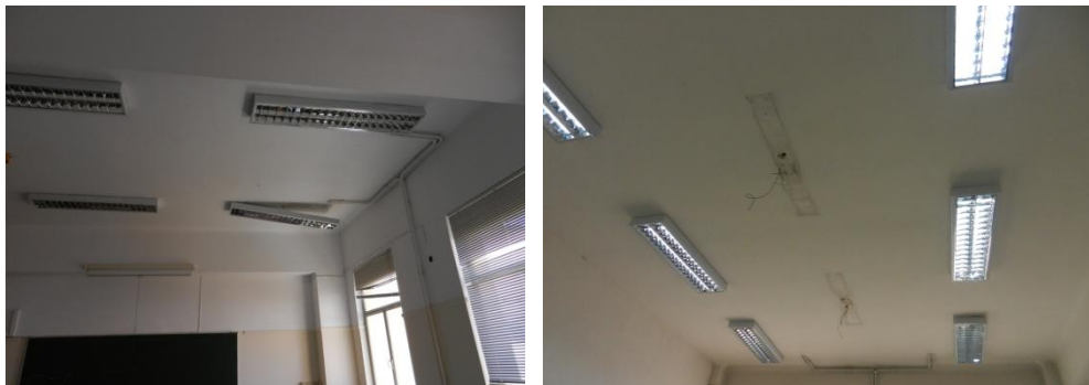
Σχήμα 4.17: Ξηλωμένα ή αφαιρεμένα γραμμικά φωτιστικά σώματα φθορισμού
