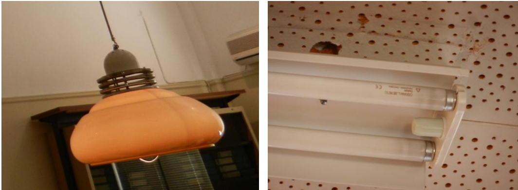
Σχήμα 4.10: Τεχνολογικά παρωχημένα φωτιστικά με λαμπτήρες πυρακτώσεως (αριστερά) ή ηλεκτρομαγνητικά ballast και λαμπτήρες φθορισμού τύπου T8 (δεξιά)
