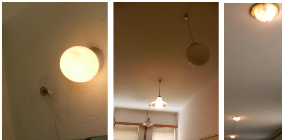
Σχήμα 4.12: Φωτιστικά με λυχνιολαβή E27 και γαλακτερό κάλυμμα
