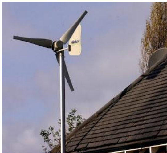
Σχήμα 1.8: Μικρή ανεμογεννήτρια εγκατεστημένη σε στέγη [Πηγή: www.windipedia.info ]
