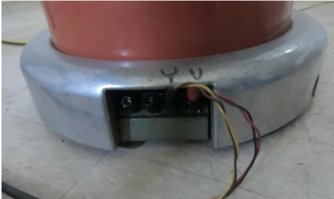
Σχήμα 8.8: Λήψεις μετασχηματιστή δοκιμών (προς γείωση και από τράπεζα χειρισμών αντίστοιχα)
