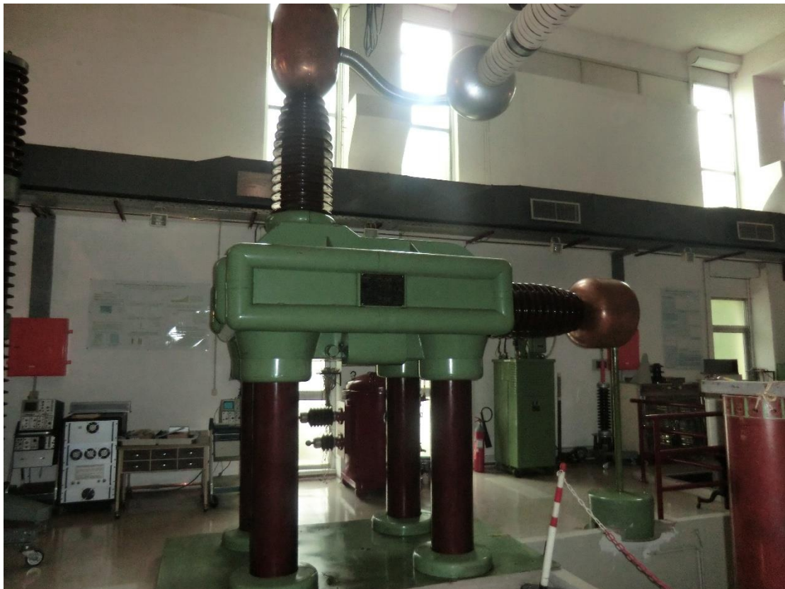
Σχήμα 8.19: Μετασχηματιστής δοκιμών 500kV/50kVA
