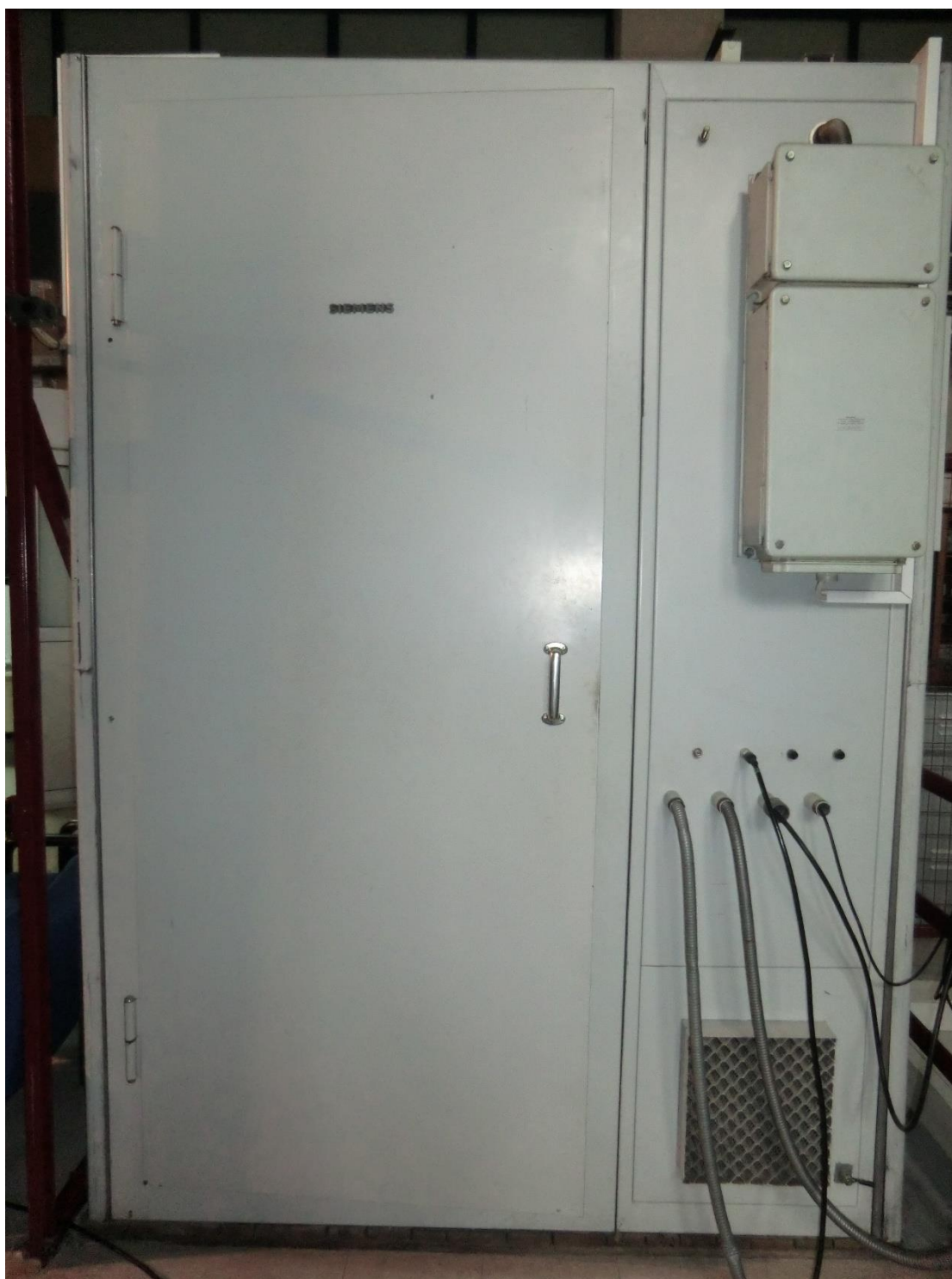
Σχήμα 8.17: Κλωβός Faraday όπου βρίσκεται το καταγραφικό σύστημα DiAS 733
