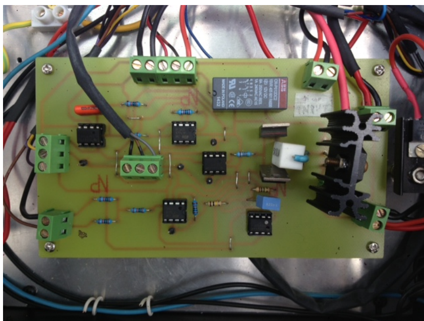
Σχήμα 4.16: Φωτογραφία του κυκλώματος ελέγχου.
