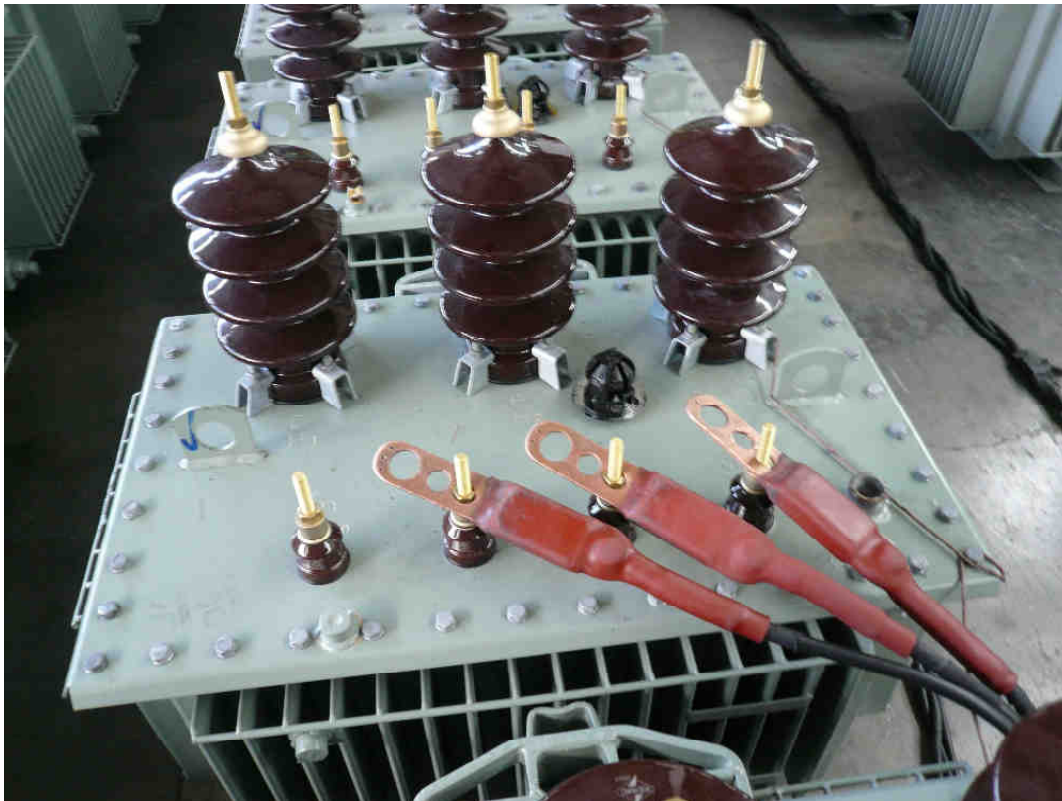
Εικόνα 3.52 – Δοκιμή μέτρησης απωλειών σιδήρου και ρεύματος μαγνήτισης
