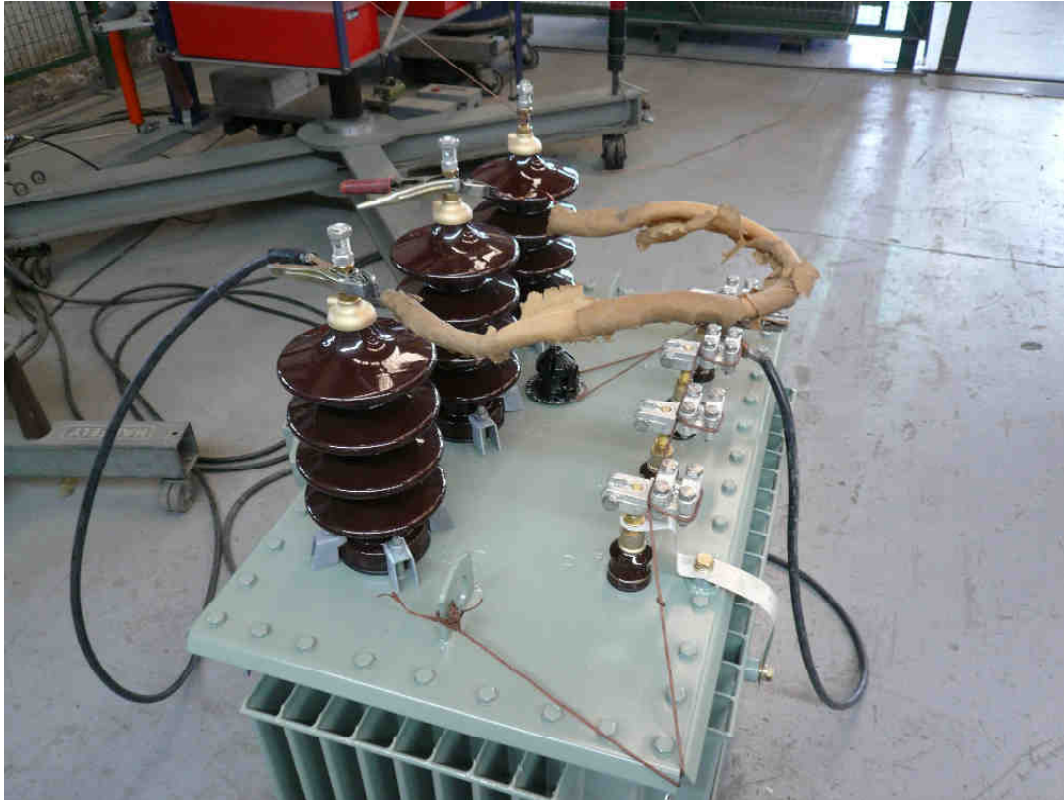
Εικόνα 3.56 – Συνδεσμολογία του υπό δοκιμή Μ/Σ. Η εξεταζόμενη φάση, στη παρούσα εικόνα, είναι η φάση Α της μέσης τάσης, με τους δύο άλλους ακροδέκτες της μέσης τάσης να είναι βραχυκυκλωμένοι και γειωμένοι. Επίσης, οι ακροδέκτες της χαμηλής τάσης και τα μεταλλικά μέρη (κάλυμμα, δεξαμενή) είναι βραχυκυκλωμένα και γειωμένα.
