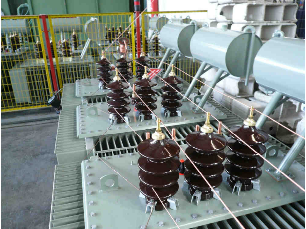
Εικόνα 3.46 – Συνδεσμολογία για την εκτέλεση της δοκιμής της εφαρμοζόμενης τάσης. Στη συγκεκριμένη εικόνα, ελέγχεται η αντοχή του τυλίγματος της μέσης τάσης (βραχυκυκλώνοντας τους τρεις ακροδέκτες αυτής και εφαρμόζοντας σε αυτούς τη τάση δοκιμής) με το τύλιγμα της χαμηλής τάσης και τα υπόλοιπα μεταλλικά μέρη (δεξαμενή, κάλυμμα) να είναι γειωμένα
