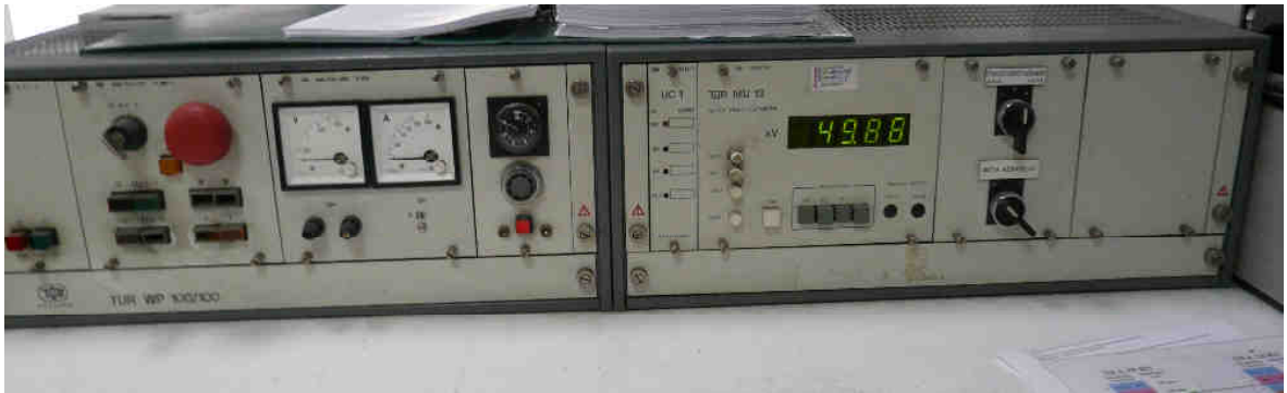
Εικόνα 3.48 – Όργανα ελέγχου εφαρμογής της τάσης δοκιμής (δοκιμή εφαρμοζόμενης τάσης)
