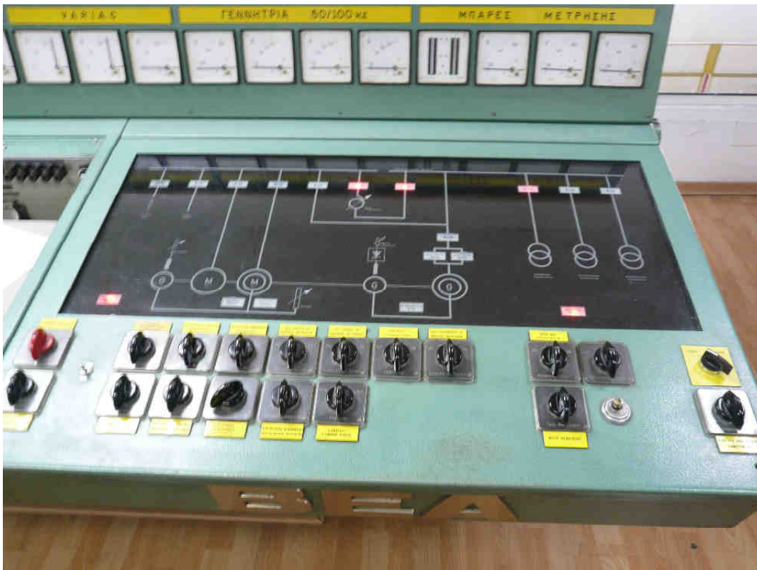
Εικόνα 3.51 – Τράπεζα ελέγχου της δοκιμής της επαγόμενης τάσης
