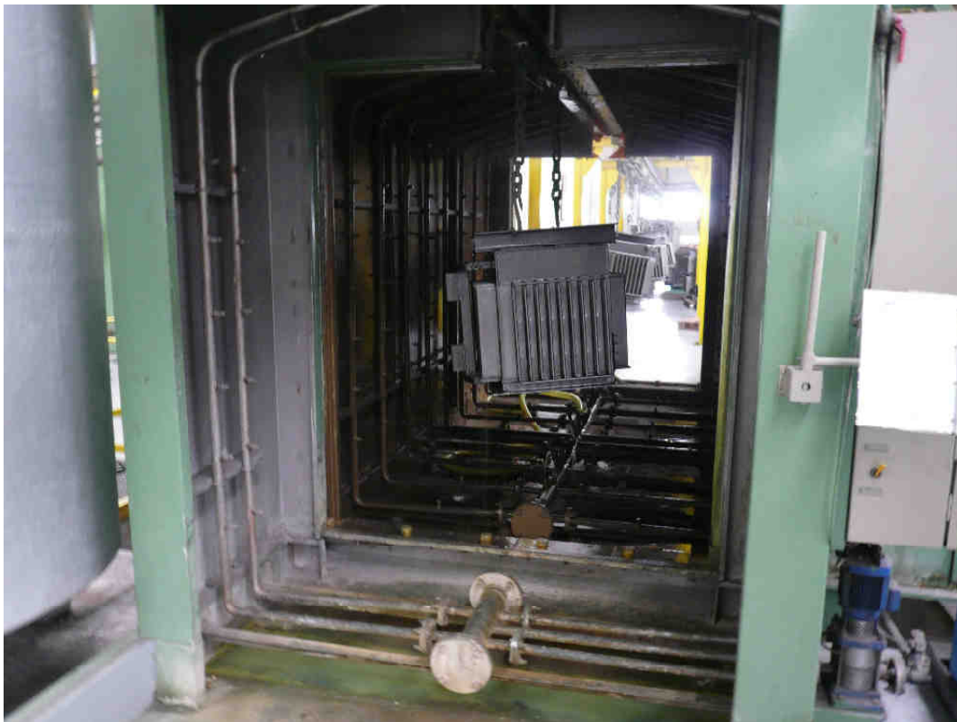
Εικόνα 3.10 - Θάλαμος απολίπανσης (απομάκρυνση παραμενουσών ακαθαρσιών) και φωσφάτωσης (δημιουργία λεπτού στρώματος φωσφορικού σιδήρου για την καλύτερη προσκόλληση του χρώματος) των δεξαμενών και των καλυμμάτων
