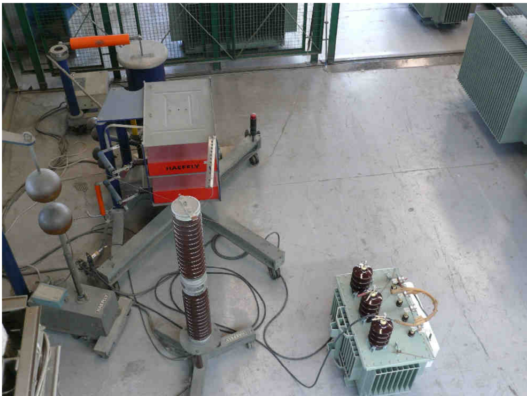
Εικόνα 3.55 – Σύστημα δοκιμής κρουστικής τάσης. Διακρίνονται: ο υπό δοκιμή Μ/Σ (100 kVA, 20/0.4 kV), η κρουστική γεννήτρια δύο σταδίων, ο σπινθηριστής για το αποκομμένο κύμα και ο χωρητικός καταμεριστής
