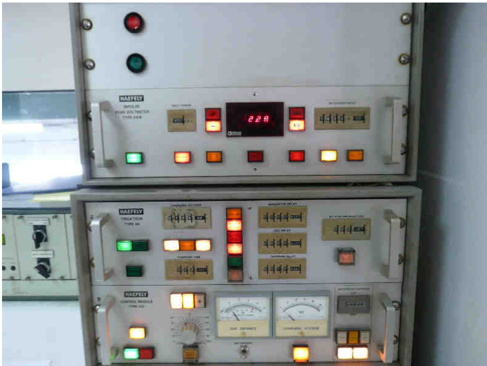
Εικόνα 3.57 – Όργανα ελέγχου διακένων σπινθηριστών και τάσης δοκιμής
