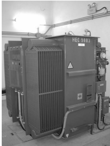
Σχήμα 1.33 Μετασχηματιστής τύπου GIS.
