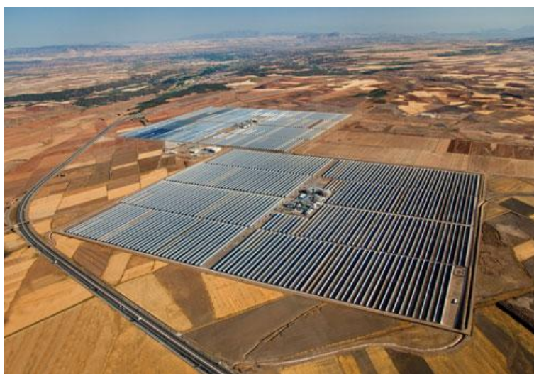
Σχήμα 2.4: Οι σταθμοί με παραβολικά κάτοπτρα Andasol 1 και 2 .
