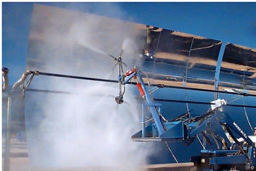
Σχήμα 3.3: Καθαρισμός των κατόπτρων με νερό υψηλής πίεσης.
