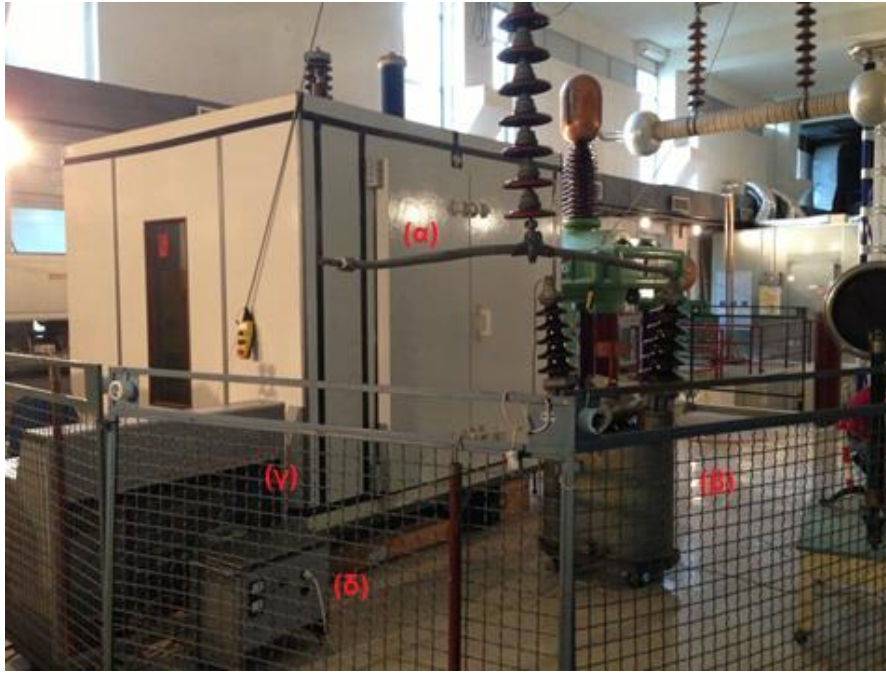
Φωτογραφία 5.1: (α) Ομοίωμα γραμμής μεταφοράς συνδεδεμένο με (β) μετασχηματιστή 100V/50kV. Αριστερά φαίνεται (γ) η τράπεζα χειρισμού της τάσης τροφοδότησης που περιλαμβάνει τον αυτομετασχηματιστή και (δ) ο σταθεροποιητής της χαμηλής τάσης του δικτύου.
