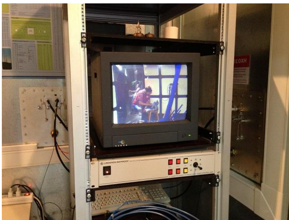
Φωτογραφία 6.2: Σύστημα παρακολούθησης της διαδικασίας που ακολουθείται μέσα στον ανεχτικό θάλαμο
