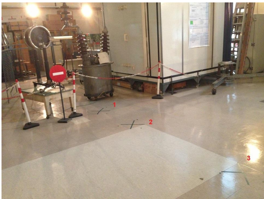
Φωτογραφία 5.2: Θέσεις μέτρησης 1, 2 και 3 του ηλεκτρικού πεδίου. Στο βάθος φαίνεται το ομοίωμα της γραμμής μεταφοράς συνδεδεμένο με τον μετασχηματιστή.
