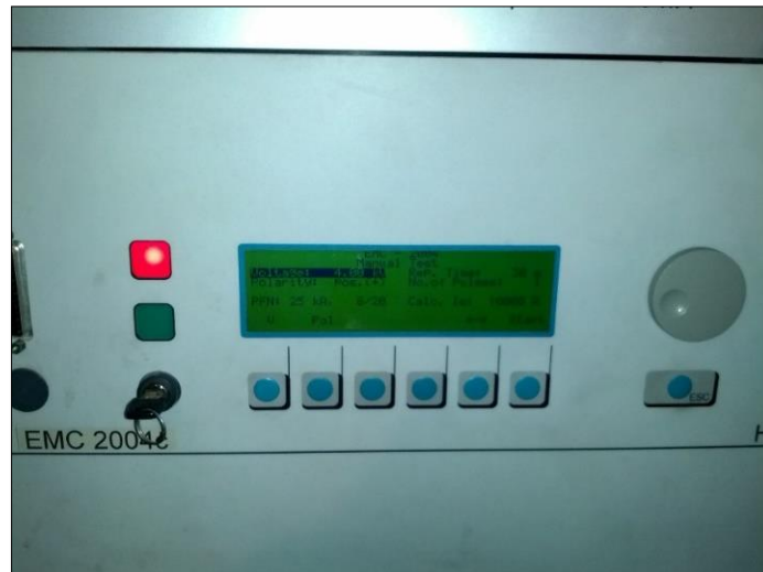
Εικόνα 4.5: Ρύθμιση τάσης φόρτισης της γεννήτριας υπό τάση
