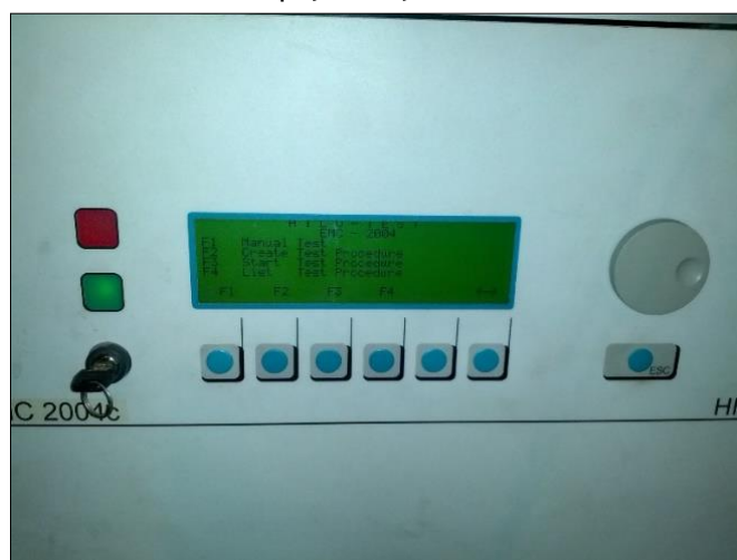
Εικόνα 4.4: Εμπρόσθιο ταμπλό γεννήτριας
