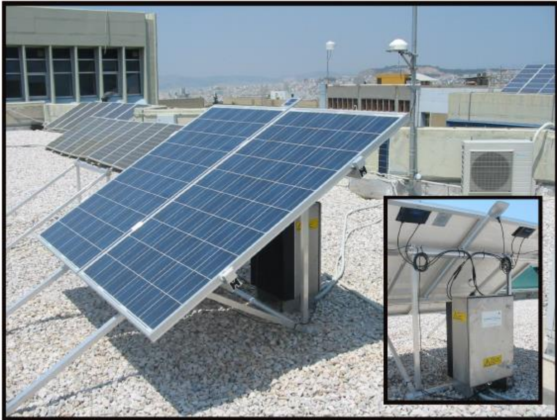
Σχήμα 7.12 Φωτογραφία από την εγκατάσταση στην οροφή του κτιρίου εργαστηρίου ΣΗΕ.
