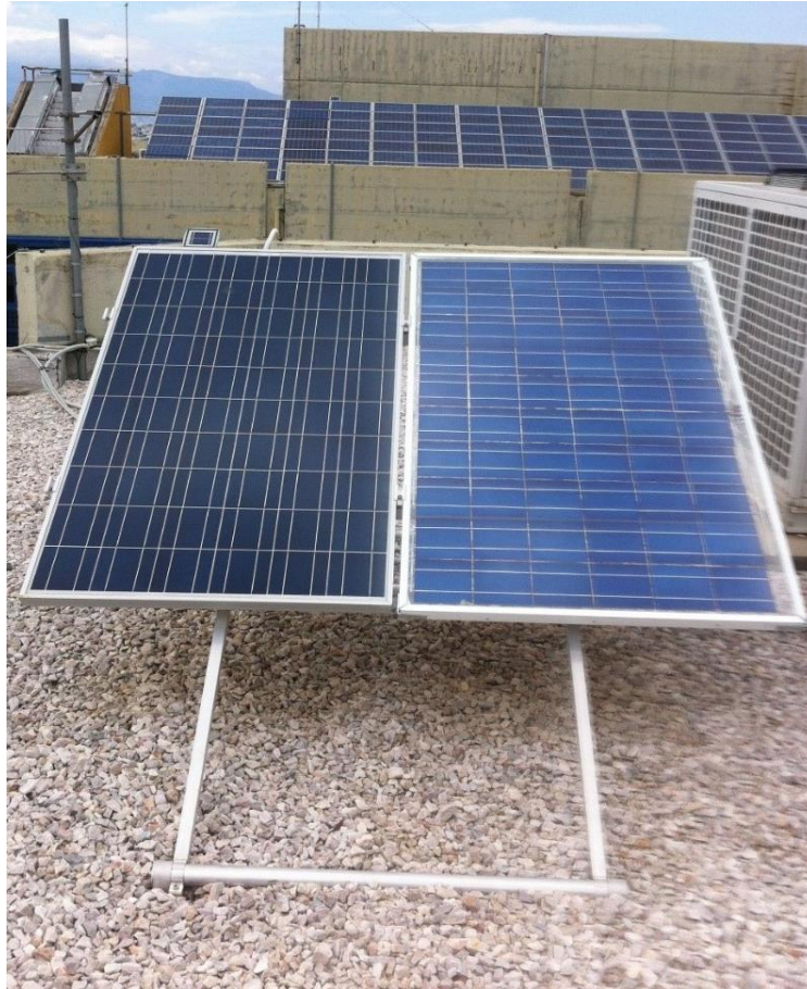
Σχήμα 8.6 Φωτογραφία των δύο πλαισίων, τοποθετημένων το ένα πλάι στο άλλο.
