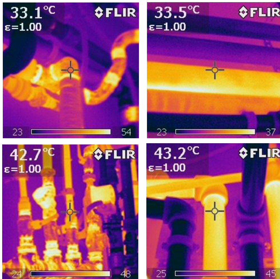
Εικόνα 4.7: Θερμογράφηση σωλήνων ζεστού νερού
