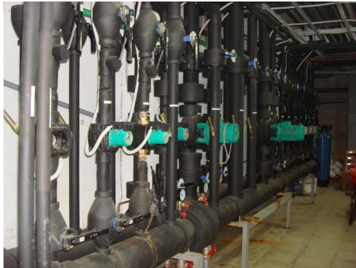
Εικόνα 3.23: Σωληνώσεις και Κυκλοφορητές
