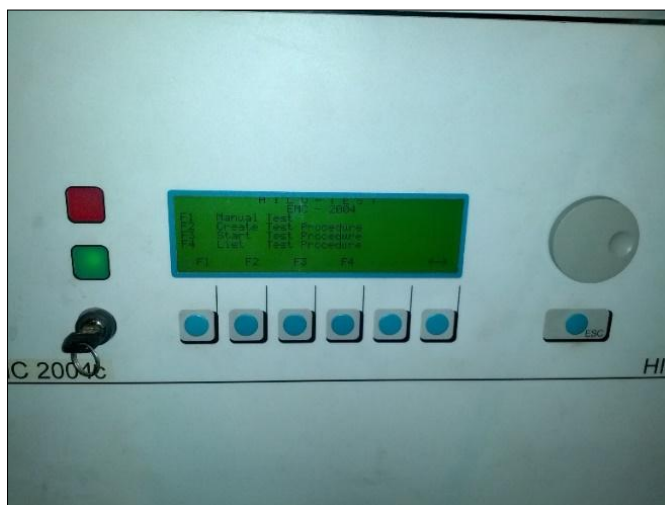
Εικόνα 4.3: Πρόσωση γεννήτριας - Πίνακας Ελέγχου Γεννήτριας
