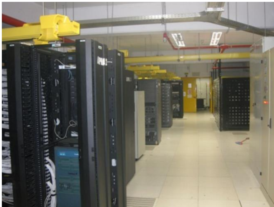
Σχήμα 1-3: Εγκατάσταση Data Center[8]
