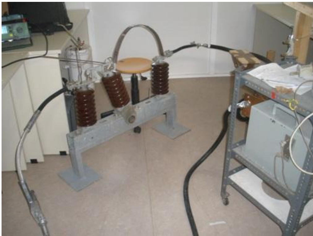
Εικόνα 3.1-1: Το κύκλωμα μέτρησης περιλαμβάνει τη διάταξη του αεροδιακόπτη και το μετασχηματιστή ρεύματος.
