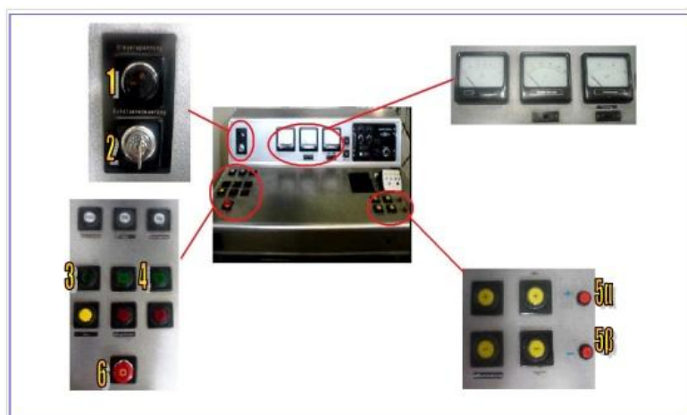
Εικόνα 3.8: Τράπεζα ελέγχου και χειρισμών
