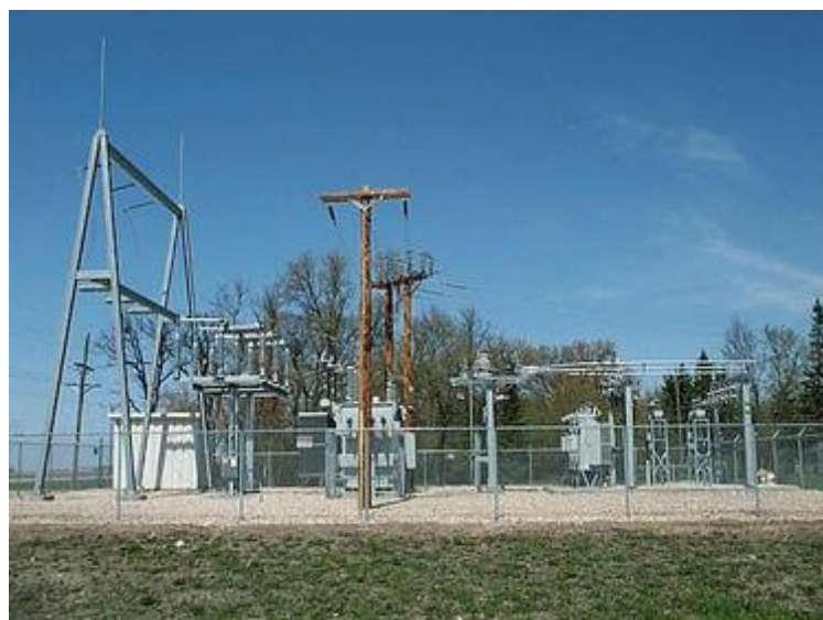
Εικόνα 1.2: Ένας τυπικός επίγειος Υ/Σ εξωτερικού χώρου μετατροπής ΥΤ/ΜΤ.
