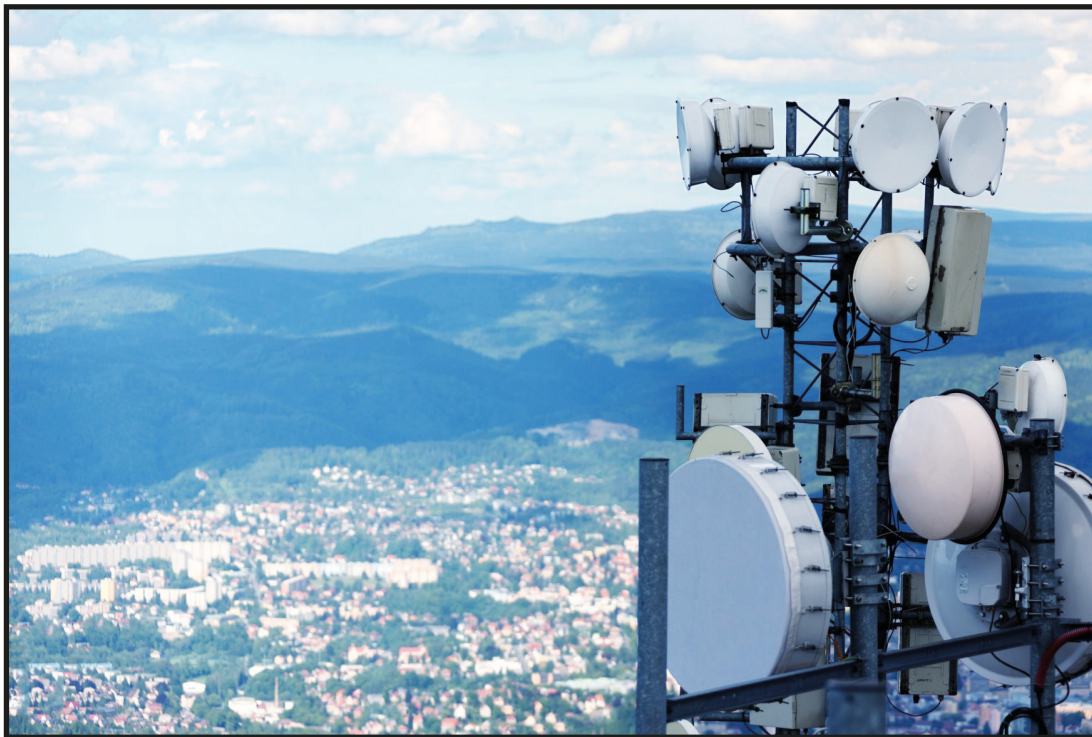
εικόνα 1.1: Κεραιοσύστημα τοποθετημένο σε ύψος που επιβλέπει αστικό ιστό
