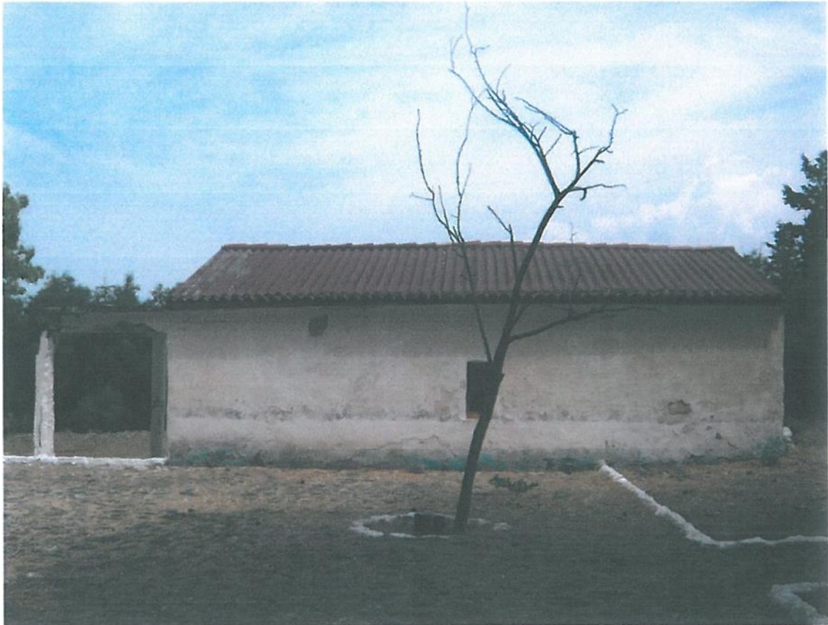
Εικόνα 38: Γενική άποψη της νότιας όψης του ναού με την επικάλυψη με νεωτερικά φύλλα αμιάντου (Πηγή: Πανέτσος et al. , 2010)
