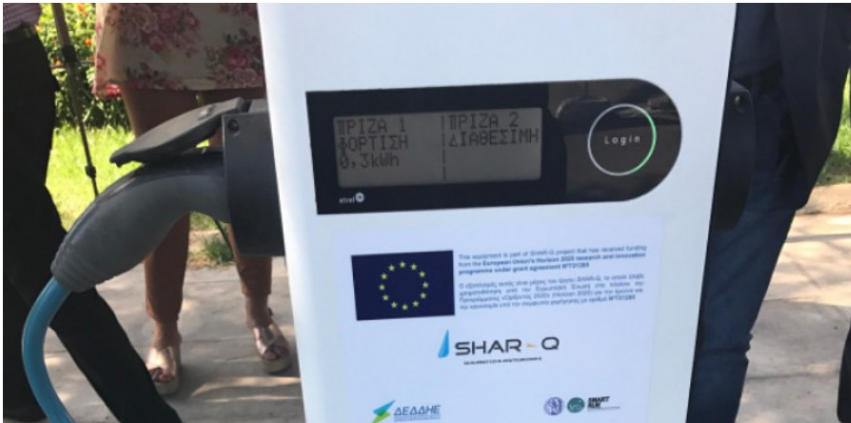
Σχήμα 2.10 Σταθμός φόρτισης ηλεκτρικού οχήματος
