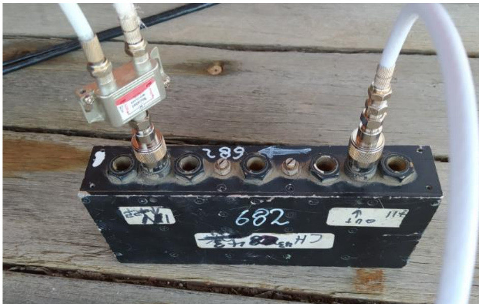
Σχ.5.5 φίλτρο cavity συντονισμένο στο 47 κανάλι.Απο το splitter συνδέθηκε μια γραμμή για τον τηλεοπτικό δέκτη και μια γραμμή για το πεδιόμετρο
