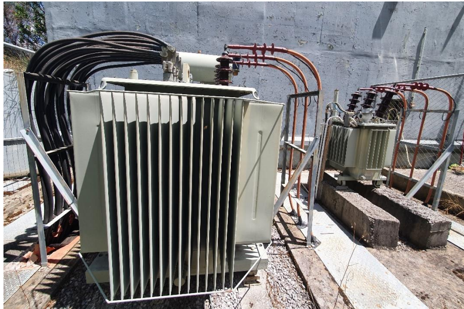
Εικόνα 3.5.1 Μετασχηματιστής ισχύος και βοηθητικός μετασχηματιστής σε ΜΥΗΕ
