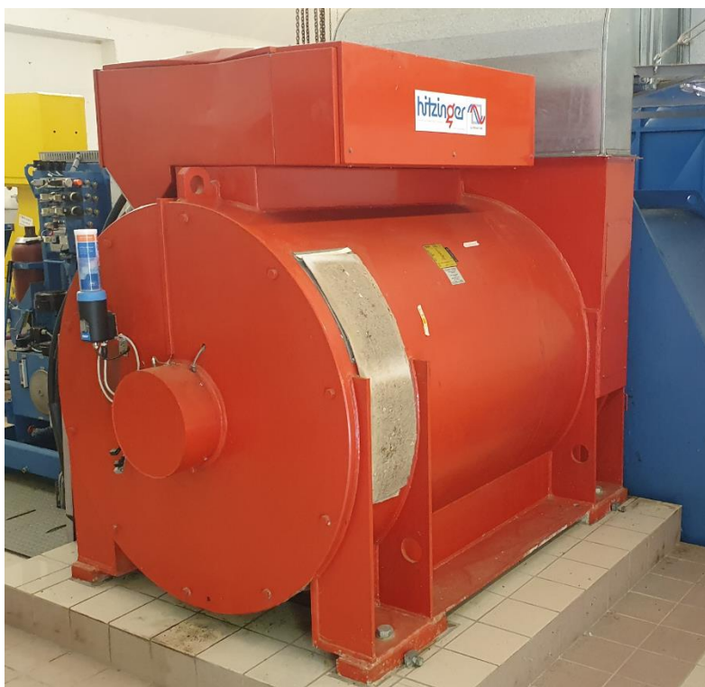
Εικόνα 3.4.5 Αερόψυκτη σύγχρονη γεννήτρια εταιρίας Hitzinger (οριζοντίου άξονα)
