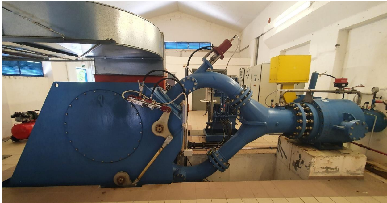
Εικόνα 3.4.2 Εγκατεστημένος υδροστροβίλος Pelton οριζοντίου άξονα με 2 ακροφύσια
