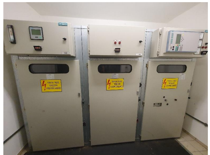
Εικόνα 2.7.3 Πίνακας μέσης τάσης με 3 κυψέλες
