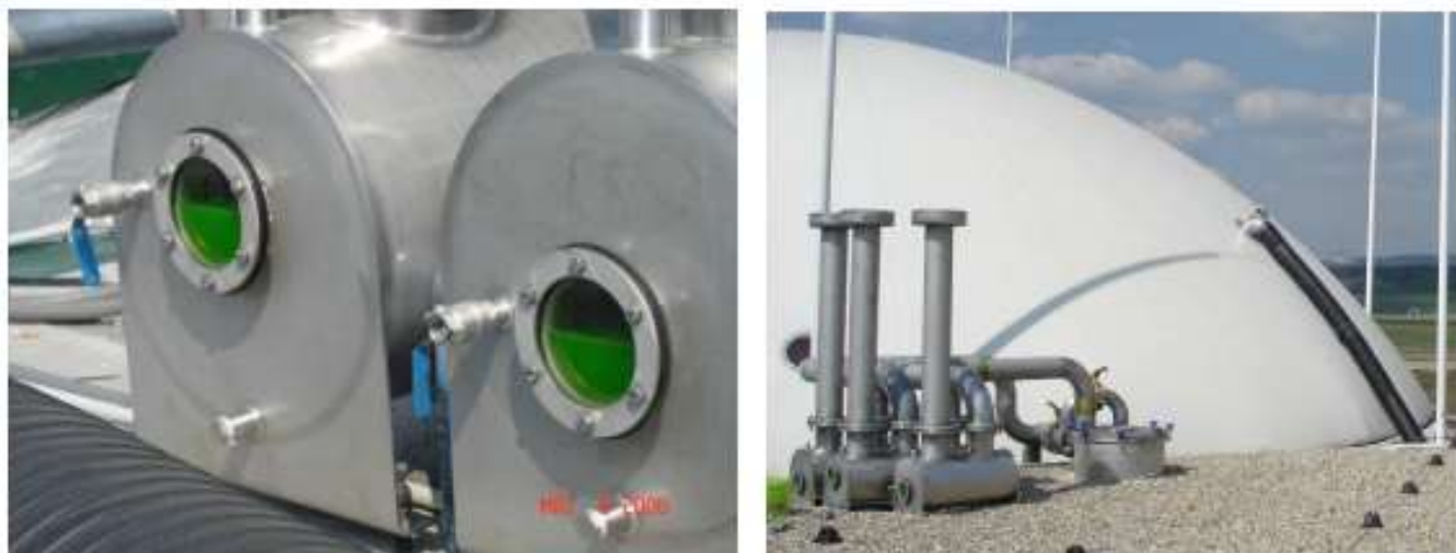
Σχήμα 4-3: Εγκαταστάσεις πίεσης και βαλβίδες ασφαλείας
