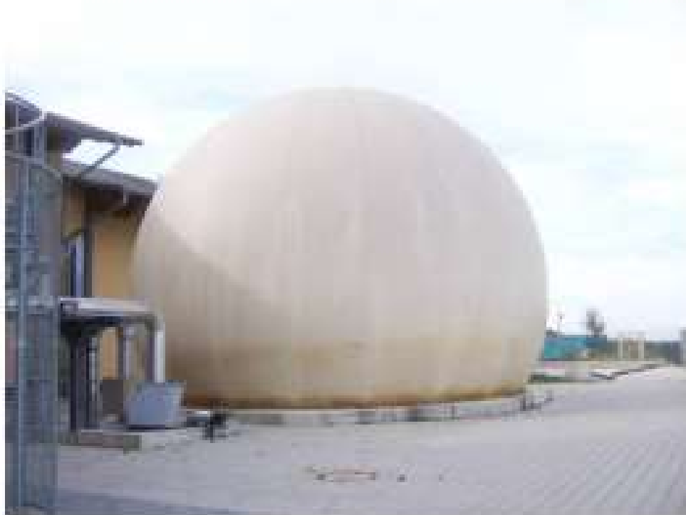
Σχήμα 4-4: Δεξαμενή αποθήκευσης χαμηλής πίεσης
