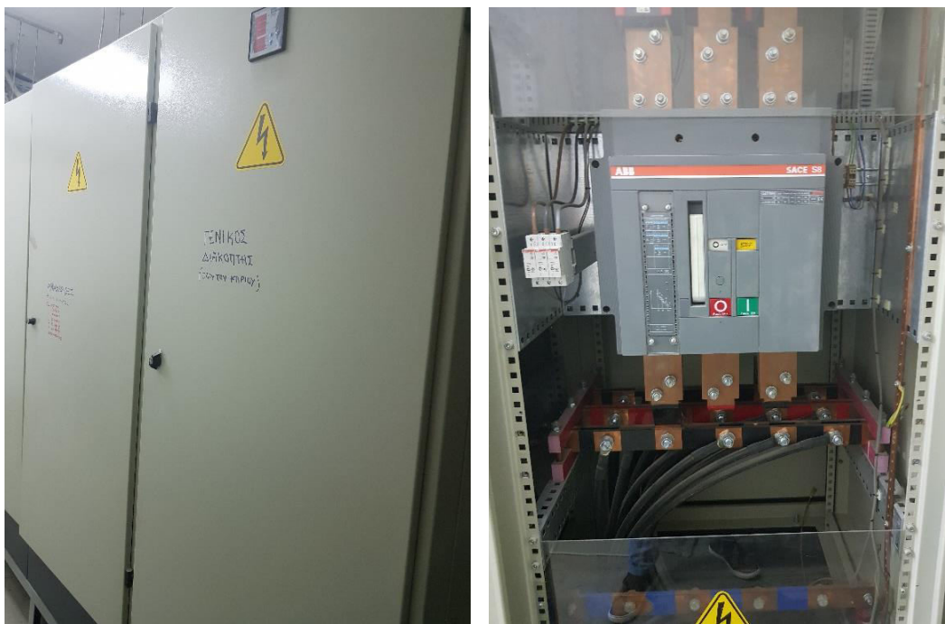
Εικόνα 142. Ο Γενικός Διακόπτης Φορτίου (ABB) στο Κεντρικό Πεδίο Εισόδου, Ονομαστικής Έντασης 2000Α. Τα καλώδια Χ.Τ. των 400Volt (μαύρα καλώδια), κουμπώνουν στις αντίστοιχες μπάρες στο κάτω μέρος του Διακόπτη, Πηγή: Προσωπικό Αρχείο
