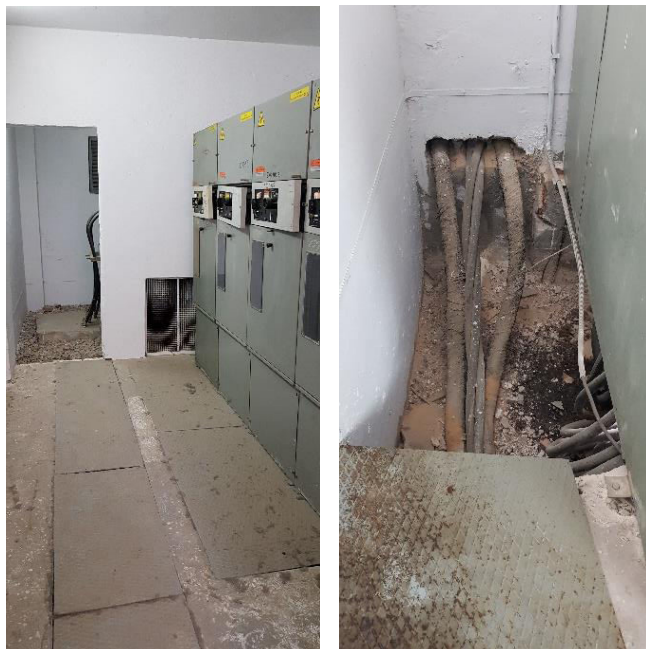
Εικόνα 44. Η όδευση των καλωδίων μέσα στον χώρο του Υ/Σ γίνεται μέσω καναλιών, Πηγή: Προσωπικό Αρχείο
