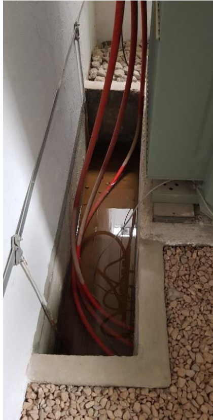
Εικόνα 82. Όδευση καλωδίων Μέσης Τάσης μέσα από ειδικά διαμορφωμένα κανάλια, είναι εμφανής η παρουσία υπογεών υδάτων , Πηγή: Προσωπικό Αρχείο
