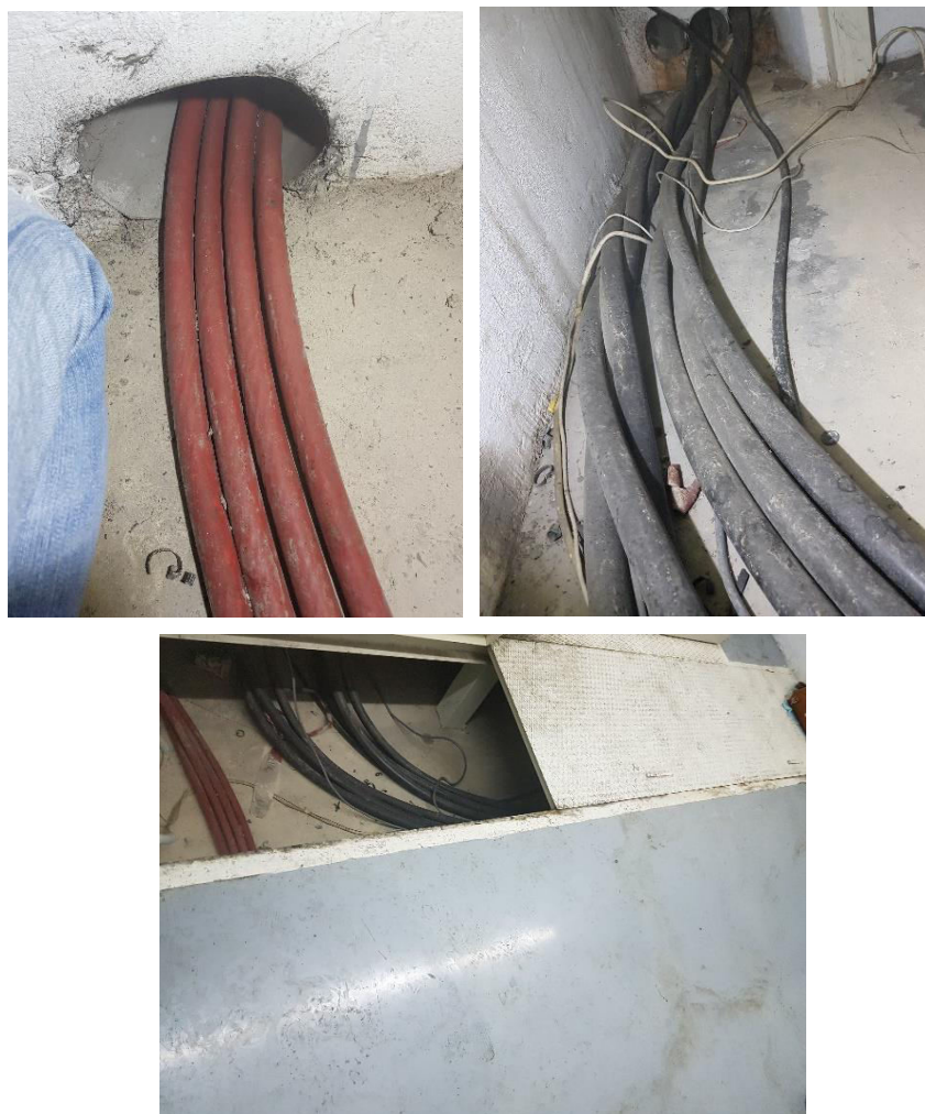
Εικόνα 135. Η εισοδος των καλωδίων Μ.Τ στον χώρο του ΔΕΔΔΗΕ γίνεται υπογείως, μέσω σωλήνων, ενώ η όδευση τους μέσα στον χώρο πραγματοποιείται μέσα από ειδικά διαμορφωμένα κανάλια που καλύπτονται με λαμαρίνες, Πηγή: Προσωπικό Αρχείο
