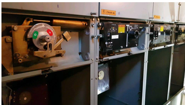
Εικόνα 117. Επανατοποθέτηση των προσόψεων των μηχανισμών λειτουργίας των Διακοπών Φορτίου στις επιμέρους Μονάδες του Πίνακα Μέσης Τάσης, μετά την ολοκλήρωση της Συντήρησης, Πηγή: Προσωπικό Αρχείο
