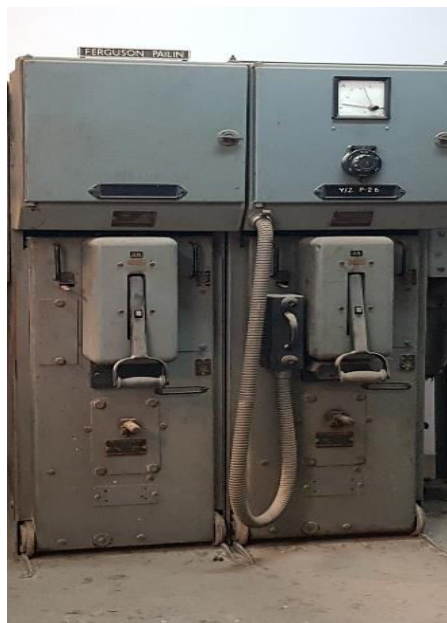
Εικόνα 35. Διακόπτες Ελαίου ( αριστερά ο Διακόπτης φορτίου στην μονάδα προς τον Υ/Σ ΠΒ-24 & δεξιά ο Διακόπτης Ισχύος με τη χαρακτηριστική φύσα, στην μονάδα προς Μ/Σ), Πηγή: Προσωπικό Αρχείο
