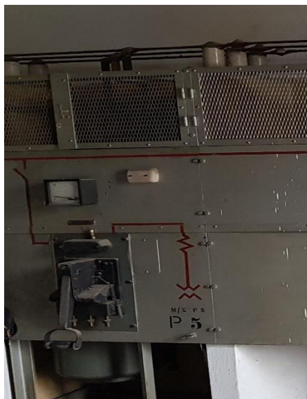
Εικόνα 21. Μονάδα Πίνακα Μέσης Τάσης προς Μ/Σ – Διακόπτης Ισχύος, Πηγή: Προσωπικό Αρχείο
