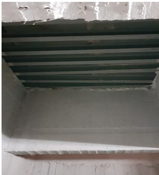
Εικόνα 59. Καταπακτή εισόδου – εξόδου μηχανημάτων του Υ/Σ με κοιλοδοκούς, Πηγή: Προσωπικό Αρχείο
