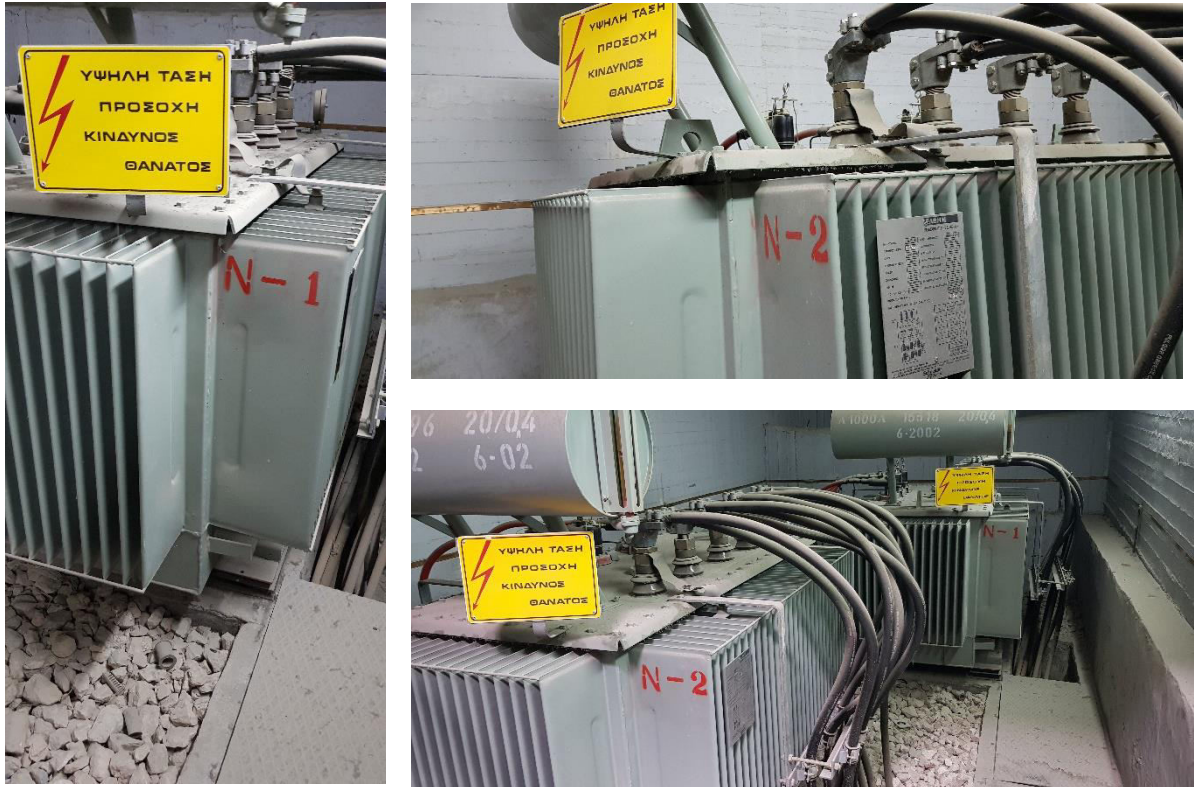
Εικόνα 60. Σημάνσεις αναγγελίας κινδύνου & Υψηλής Τάσης στον χώρο των Μ/Σ, Πηγή: Προσωπικό Αρχείο
