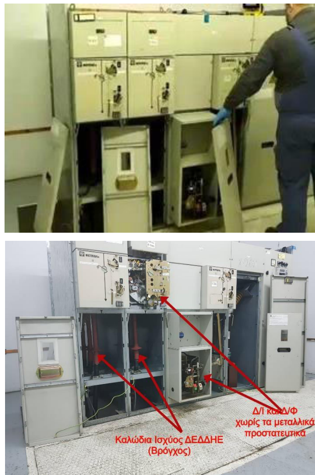
Εικόνα 121. Ο Πίνακας Μέσης Τάσης του Πελάτη Μ.Τ. Χ-2641 αποσυναρμολογημένος, Πηγή: Προσωπικό Αρχείο
