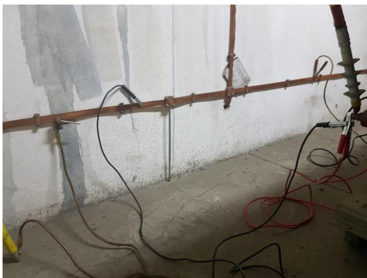
Εικόνα 139. Ισοδυναμικό Πλέγμα, Αναμονές, Περιμετρική Γείωση & Γειώσεις Εργασίας στον χώρο του Μ/Σ Ισχύος, Πηγή: Προσωπικό Αρχείο
