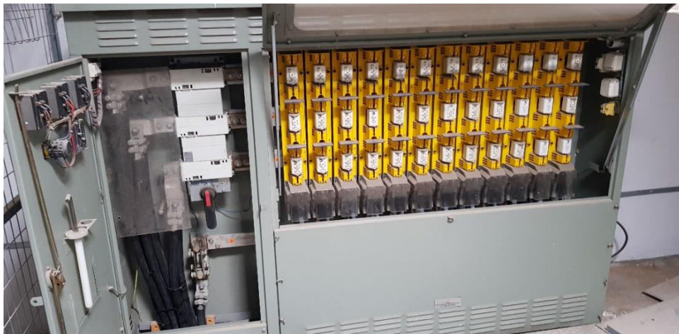
Εικόνα 76. Ο Πίνακας Χαμηλής Τάσης του Υ/Σ ΠΚ-92 διαθέτει 12 Αναχωρήσεις και λειτουργεί με Διακόπτη Φορτίου, Πηγή: Προσωπικό Αρχείο
