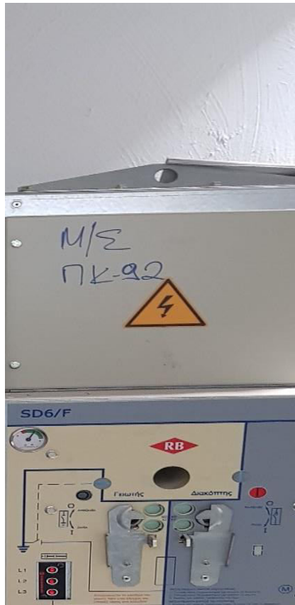
Εικόνα 80. Σήμανση αναγγελίας Υψηλής Τάσης στον Πίνακα Μέσης Τάσης, Πηγή: Προσωπικό Αρχείο
