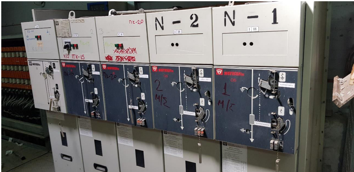
Εικόνα 61. Σύγχρονος Πίνακας Μέσης Τάσης με Διακόπτες Φορτίου με μόνωση SF6, Πηγή: Προσωπικό Αρχείο
