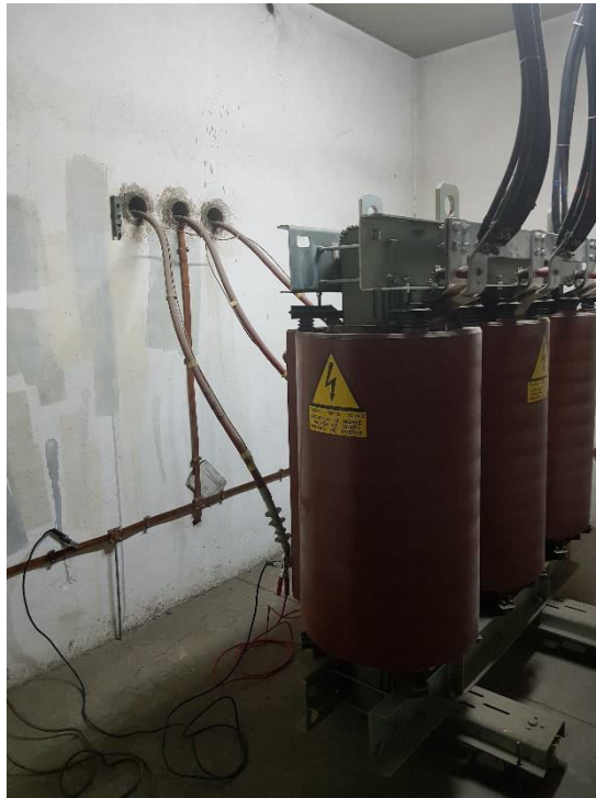
Εικόνα 138. Ο Μ/Σ που είναι εγκατεστημένος στον χώρο του Πελάτη Μ.Τ. είναι Ξηρού Τύπου & η μετακίνηση του μέχρι την τελική του θέση γίνεται με κύληση στους τέσσερις τροχούς του, Πηγή: Προσωπικό Αρχείο
