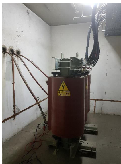
Εικόνα 140. Όδευση του Παροχικού Καλωδίου 20kV από τον Πίνακα Μ.Τ. του ΓΑΛΑΞΙΑ προς τον Μ/Σ Ισχύος, μέσω ειδικών σωλήνων που έχουν στεγανοποιηθεί και σύνδεση του στους ακροδέκτες Μ.Τ. του Μ/Σ Ισχύος, Πηγή: Προσωπικό Αρχείο
