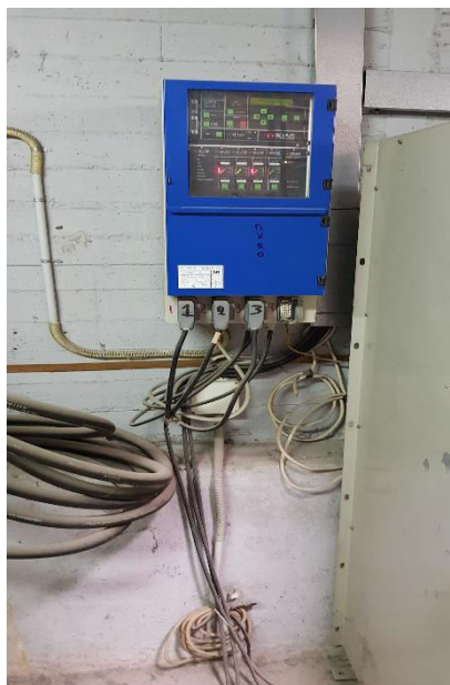
Εικόνα 63. Μονάδα RTU ( Remote Terminal Unit) για τηλεχειρισμούς, Πηγή: Προσωπικό Αρχείο
