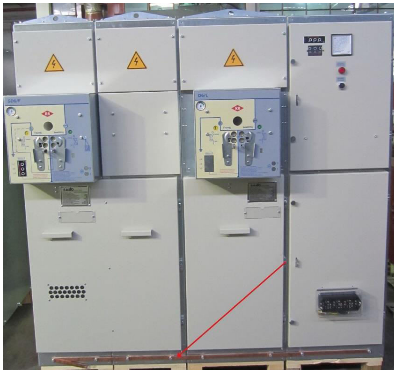
Εικόνα 87. Γείωση μεταλλικών μερών Πίνακα Μέσης Τάσης, παρατηρούμε ότι στη βάση του πίνακα υπάρχουν χάλκινες λάμες οι οποίες ενώνουν τις μονάδες μεταξύ τους, Πηγή: Προσωπικό Αρχείο
