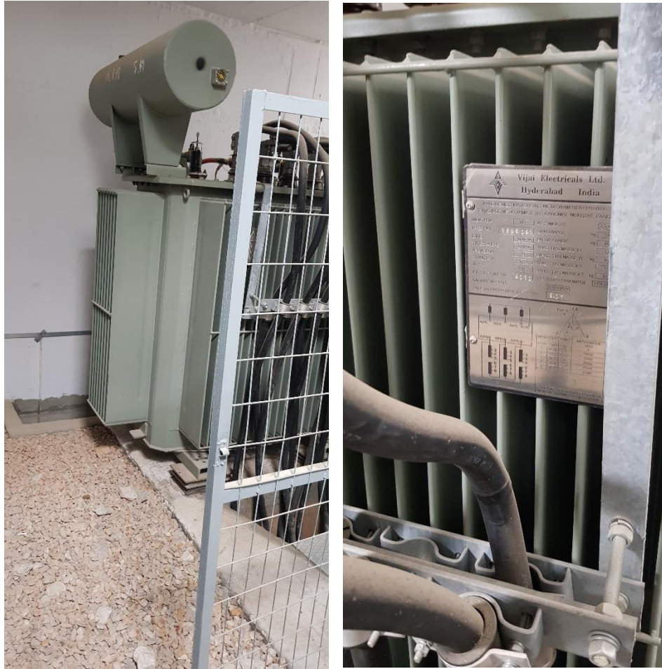
Εικόνα 75. Ο Μ/Σ Ισχύος 1000KVA του Υ/Σ ΠΚ-92 – Πινακίδα Μ/Σ, Πηγή: Προσωπικό Αρχείο
