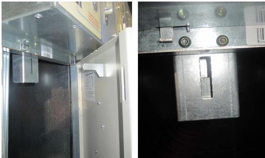
Εικόνα 57. Πόρτα Πίνακα Μέσης Τάσης – Αλληλασφαλίσεις, Πηγή: Προσωπικό Αρχείο
