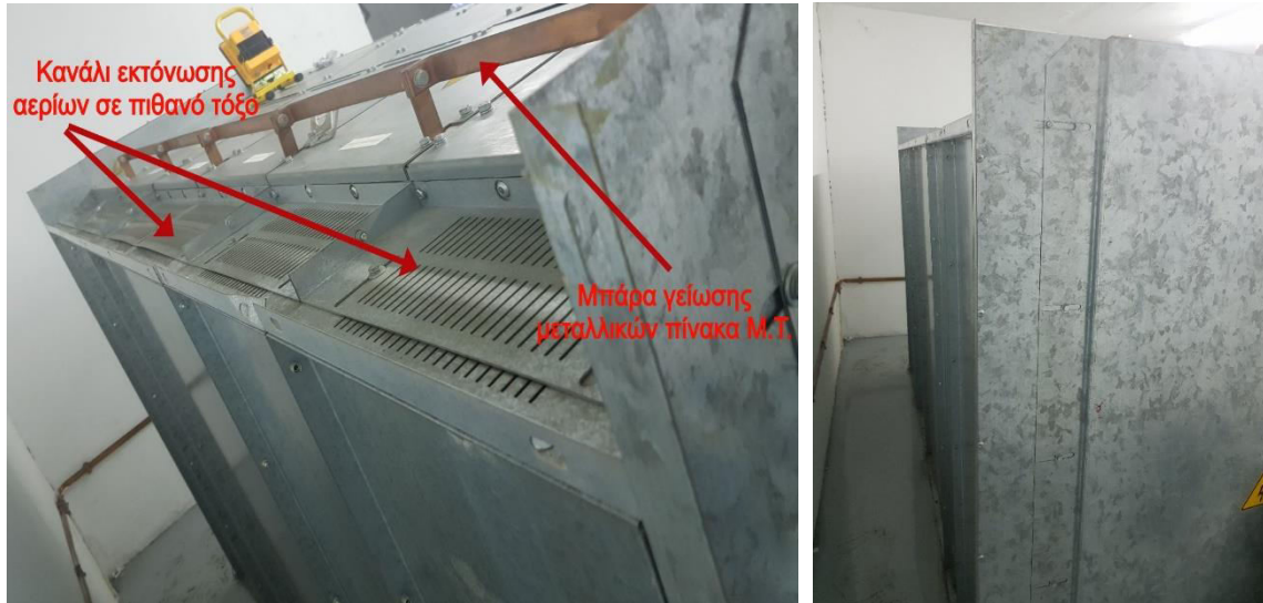
Εικόνα 132. Ενισχυμένη η μεταλλική κατασκευή του Πίνακα Μέσης Τάσης στο πίσω μέρος του, για την εκτόνωση του μονωτικού αερίου SF 6 σε περίπτωση βραχυκυκλώματος.
