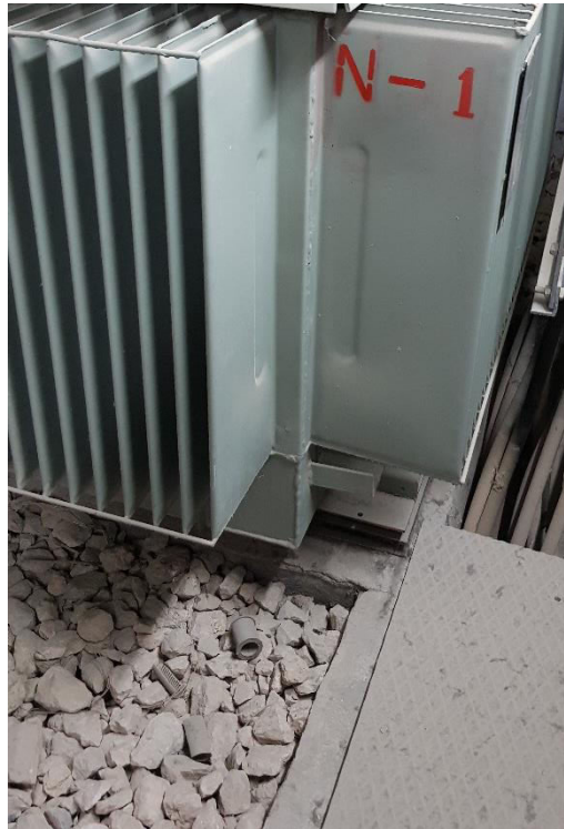
Εικόνα 71. Τοποθέτηση των Μ/Σ πάνω σε τσιμέντινες βάσεις μέσω των ειδικών μεταλλικών πελμάτων, μέσα σε χώρο με χαλίκια (κροκάλες) για την απορρόφηση των ελαίων από ενδεχόμενη διαρροή, Πηγή: Προσωπικό Αρχείο
