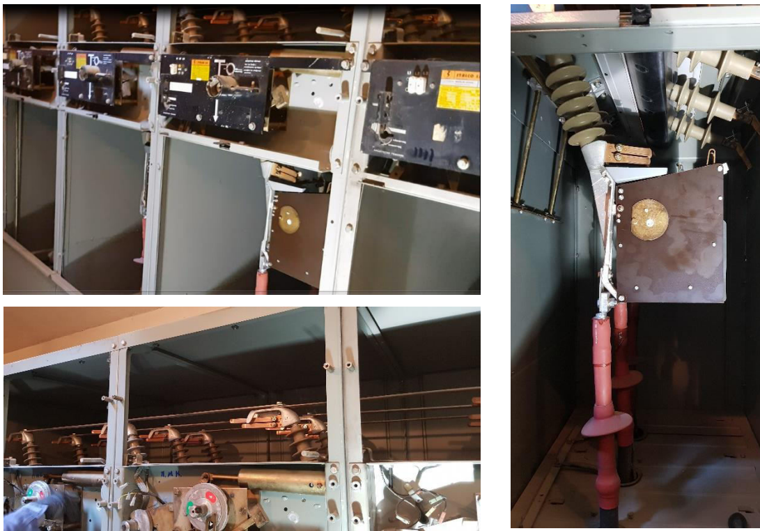
Εικόνα 106. Διαδικασία Συντήρησης Πίνακα Μέσης Τάσης σε πλήρη εξέλιξη, διακρίνονται οι Ζυγοί Μέσης Τάσης, ο μηχανισμός λειτουργίας του Διακόπτη Φορτίου και ο Διακόπτης Φορτίου στη μονάδα αφίξης του Πίνακα προς Κ/Δ Αιγάλεω μαζί με τα ακροκιβώτια του υπογείου καλωδίου Μέσης Τάσης, Πηγή: Προσωπικό Αρχείο
