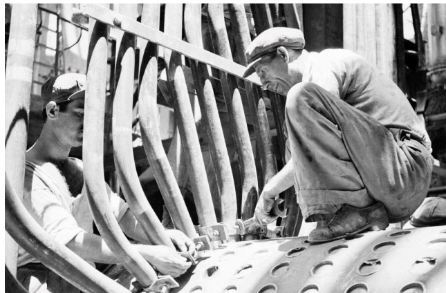
Εικόνα 15. Emile (Αιμίλιος Σεράφης), Εργασίες στον νέο λέβητα του Σταθμού Νέου Φαλήρου, Ιούνιος 1950, Πηγή: Ιστορικό Αρχείο ΔΕΗ
