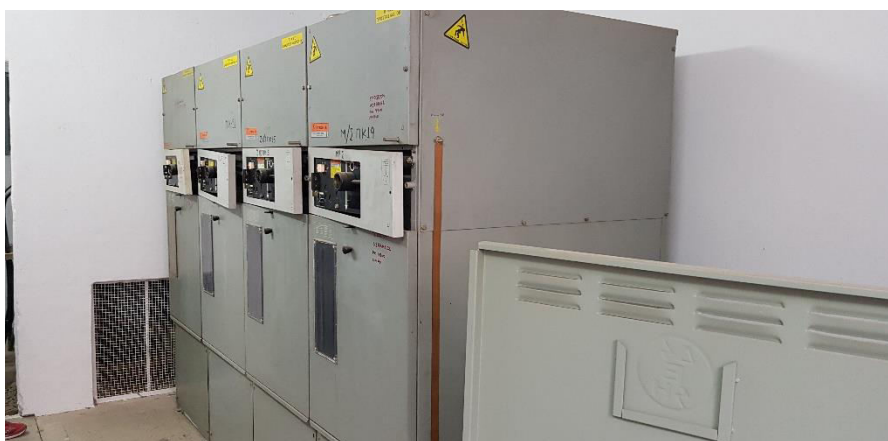
Εικόνα 38. Νεότερος Πίνακας Μέσης Τάσης με τέσσερις επιμέρους καμπίνες, Πηγή: Προσωπικό Αρχείο
