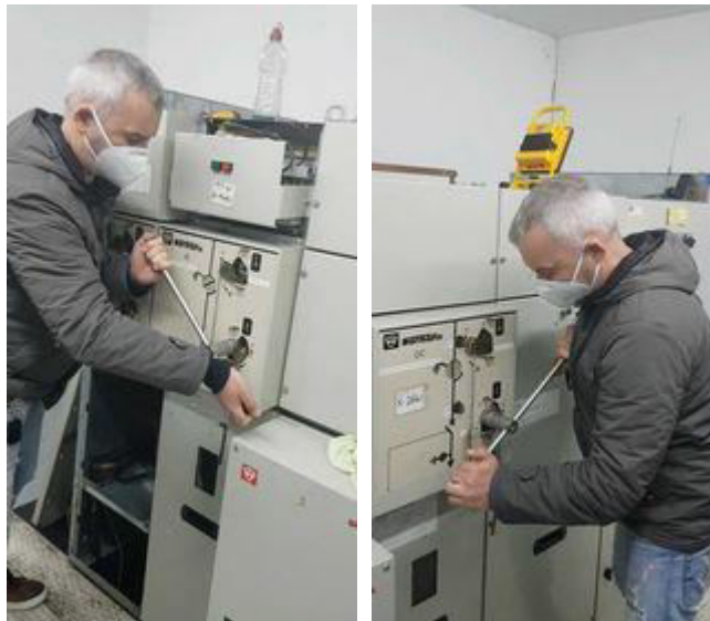
Εικόνα 125. Α: Χειρισμός του Διακόπτη Φορτίου στο Πεδίο Προστασίας του Πίνακα Μ.Τ Β: Χειρισμός του Διακόπτη Φορτίου (Δ/Φ) στο Πεδίο Αναχώρησης του Πίνακα Μ.Τ Πηγή: Προσωπικό Αρχείο
