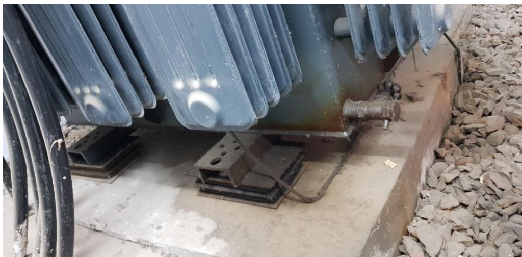
Εικόνα 41. Ο Μ/Σ είναι τοποθετημένος σε ξεχωριστό χώρο με χαλίκια μέσωτσιμέντινης βάσης για την απορρόφηση τυχόν διαρροής ελαίου & «πατάει» πάνω στα ειδικά πέλματα για την μείωση της δόνησης που προκαλείται κατά τη λειτουργία του, Πηγή: Προσωπικό Αρχείο.
