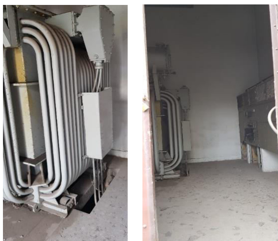
Εικόνα 24. Σύνδεση Πίνακα Μέσης Τάσης – Μ/Σ, μέσω τριών μονοπολικών καλωδίων Cu, διατομής 25-30mm 2 , Πηγή: Προσωπικό Αρχείο
