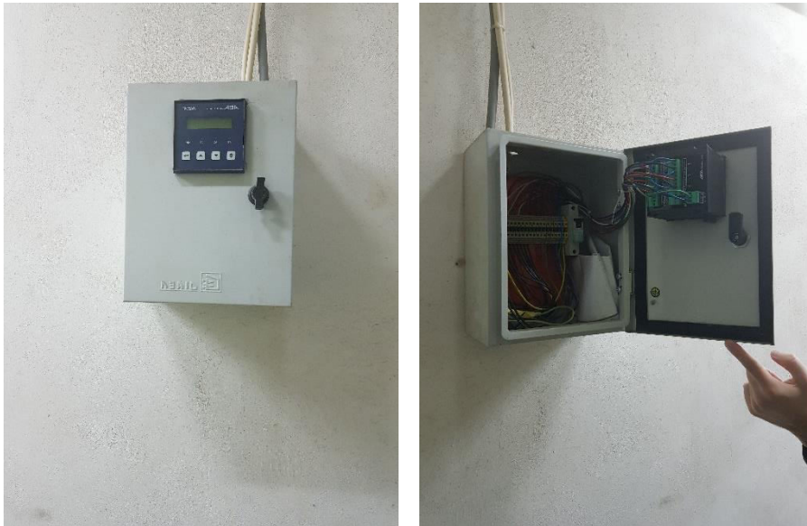
Εικόνα 146. Η παρακολούθηση της θερμοκρασίας του χώρου αλλά και των τυλιγμάτων του Μ/Σ Ισχύος του Πελάτη Μ.Τ., γίνεται μέσω του ειδικού αυτού μηχανισμού που βρίσκεται εγκατεστημένος στον χώρο του Γενικού Πίνακα Διανομής Χ.Τ., Πηγή: Προσωπικό Αρχείο
