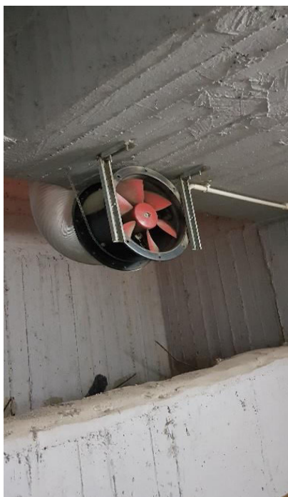
Εικόνα 69. Ο Ανεμιστήρας εξασφαλίζει τον τεχνητό αερισμό του Υ/Σ , Πηγή: Προσωπικό Αρχείο
