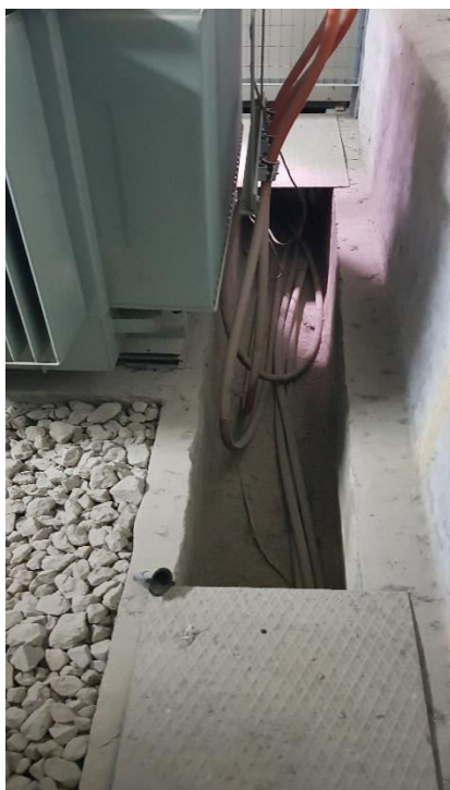
Εικόνα 70. Όδευση καλωδίων στον χώρο του Υ/Σ μέσα από ειδικά κατασκευασμένα κανάλια, Πηγή: Προσωπικό Αρχείο
