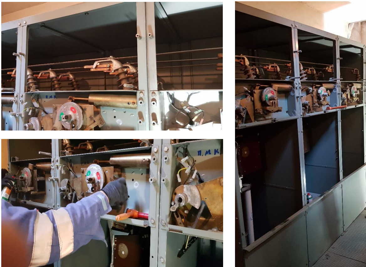
Εικόνα 105. Διαδικασία Συντήρησης Πίνακα Μέσης Τάσης σε πλήρη εξέλιξη, διακρίνονται οι Ζυγοί Μέσης Τάσης και τα μηχανικά μέρη των επιμέρους μονάδων, Πηγή: Προσωπικό Αρχείο
