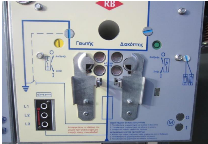
Εικόνα 54. Πρόσωση Διακόπτη Προστασίας Μ/Σ, Πηγή: Προσωπικό Αρχείο
