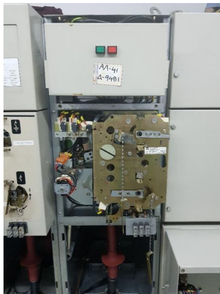
Εικόνα 127. Ο Μηχανισμός Λειτουργίας του Διακόπτη Φορτίου στην Μονάδα Αναχώρησης του Υπογείου καλωδίου Μ.Τ. προς τον γειτονικό Υ/Σ ΑΛ-41, Πηγή: Προσωπικό Αρχείο
