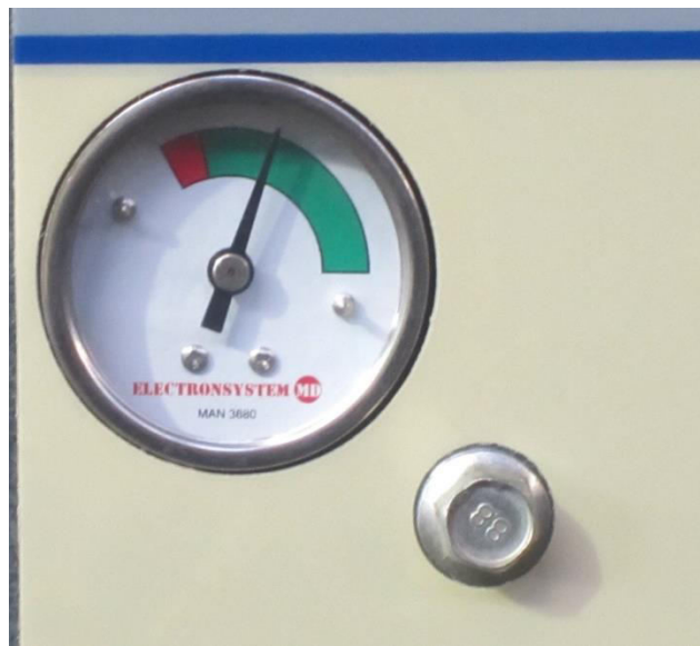
Εικόνα 78. Μανόμετρο στον Πίνακα Μέσης Τάσης, Πηγή: Προσωπικό Αρχείο
