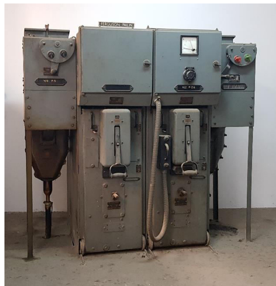
Εικόνα 34. Ο Πίνακας Μέσης Τάσης στον μεταγενέστερο Υ/Σ Πόλεως Ρ-26, Πηγή: Προσωπικό Αρχείο
