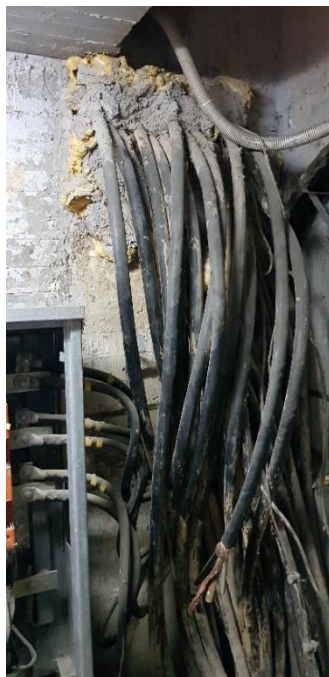
Εικόνα 66. Όδευση καλωδίων Χαμηλής Τάσης από τον χώρο του Υ/Σ προς τους καταναλωτές, Μπούκες καλωδίων, Πηγή: Προσωπικό Αρχείο
