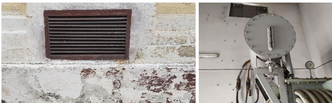
Εικόνα 28. Οι αεροθυρίδες κάτω από το δάπεδο του κτιρίου αλλά και στο άνω τμήμα του, εξασφαλίζουν τη φυσική ροή του αέρα που ψύχει τον εσωτερικό χώρο, Πηγή: Προσωπικό Αρχείο
