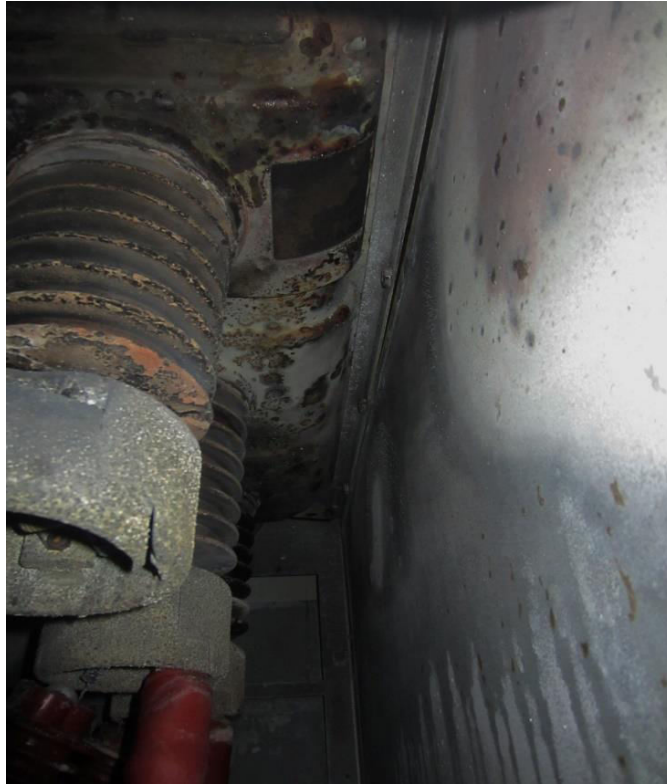
Εικόνα 97. Βραχυκύκλωμα στον χώρο των ακροκιβωτίων στη μονάδα άφιξης του Πίνακα Μ.Τ. Πηγή: [14]
