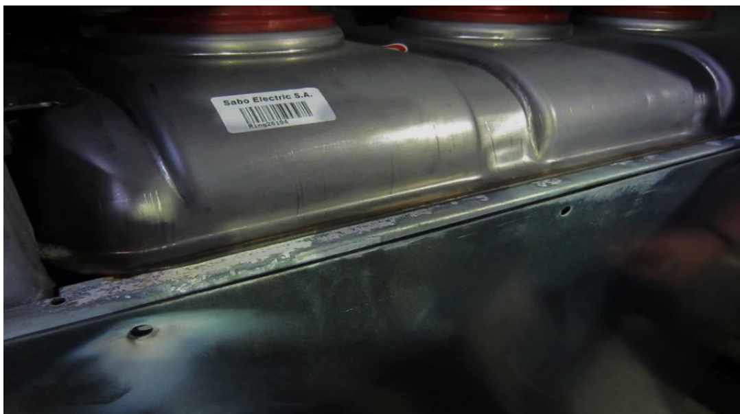
Εικόνα 95. Διάβρωση της λαμαρίνας του τανκ του Διακόπτη Φορτίου λόγω κακής βαφής, Πηγή: [14]
