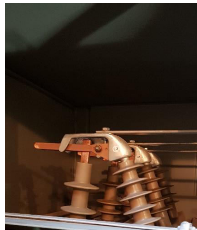
Εικόνα 109. Ο Διακόπτης Φορτίου προς τους Ζυγούς Μέσης Τάσης: Α: Στη μονάδα άφιξης – Με Δύο σταθερές επαφές Β: Στην μονάδα προστασίας του Μ/Σ – Με Μία σταθερή επαφή Πηγή: Προσωπικό Αρχείο
