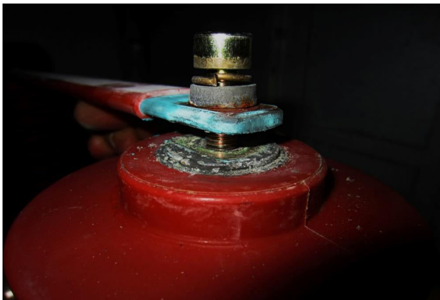
Εικόνα 94. Βραχυκύκλωμα στο χώρο των ακροκιβωτίων λόγω υγρασίας, Πηγή: [14]
