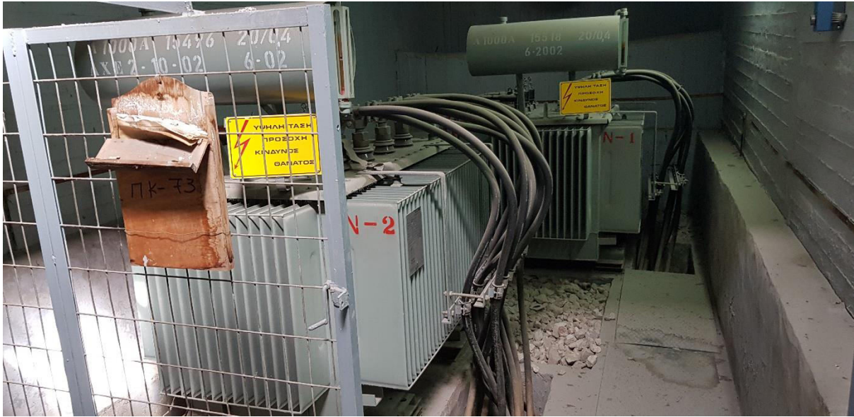
Εικόνα 64. Οι Μ/Σ Ισχύος N-1 και N-2 του Υπόγειου Υ/Σ Πόλεως ΠΚ-73, 1000 KVA ο κάθε ένας, Πηγή: Προσωπικό Αρχείο
