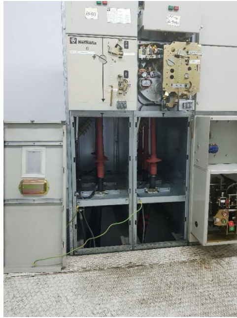
Εικόνα 122. Τα Πεδία Άφιξης & Αναχώρησης του υπογείων καλωδίου Μ.Τ. , με Διακόπτες Φορτίου (Δ/Φ) με μόνωση SF 6 παρατηρούμε τα ακροκιβώτια των υπογείων καλωδίων , Πηγή: Προσωπικό Αρχείο
