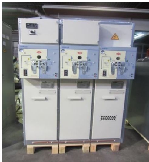
Εικόνα 51. Πίνακες Μέσης Τάσης που φέρουν διακόπτη φορτίου με μόνωση SF6, Πηγή: Προσωπικό Αρχείο
