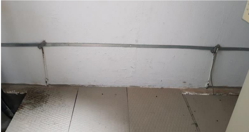
Εικόνα 86. Η Περιμετρική Γείωση του Υ/Σ Διανομής Πόλεως 20/0,4 kV ΠΚ-92, Πηγή: Προσωπικό Αρχείο
