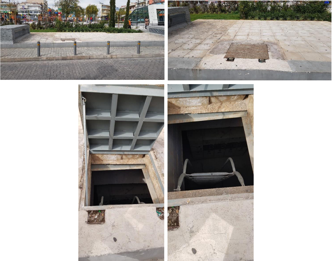
Εικόνα 58. Είσοδος του Υπόγειου Υ/Σ Πόλεως ΠΚ-73 στον Κορυδαλλό, Πηγή: Προσωπικό Αρχείο
