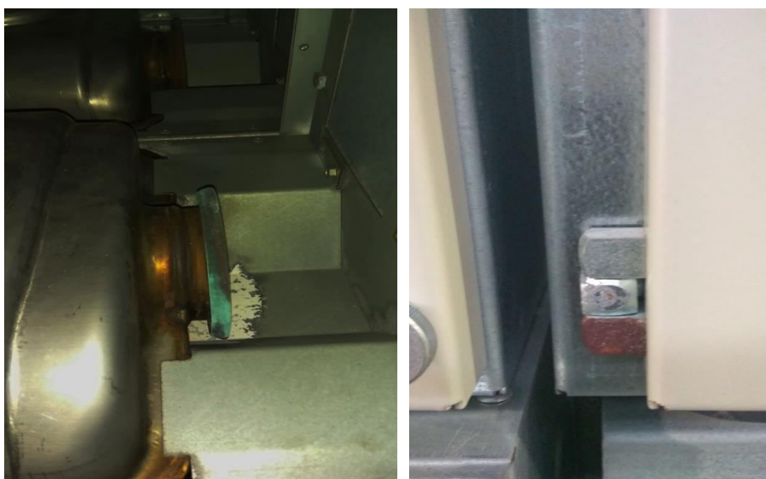
Εικόνα 96. Α. Διάβρωση στο στόμιο εκτόνωσης του Διακόπτη Φορτίου λόγω υγρασίας Β. Σκουριά σε μεντεσέ θύρας του Πίνακα Μέσης Τάσης Πηγή: [14]
