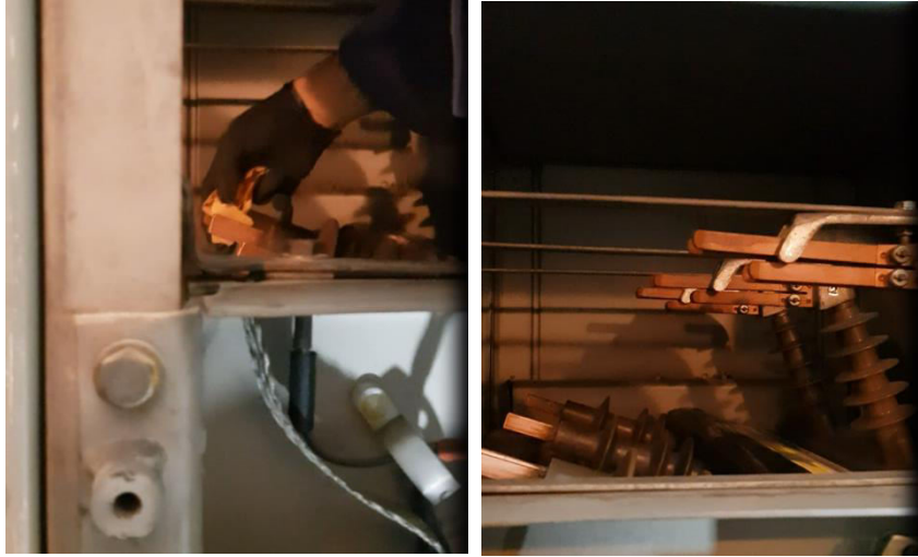
Εικόνα 112. Τρίψιμο των επαφών του Διακόπτη Φορτίου με γυαλόχαρτο, στην Μονάδα Αφιξης του υπογείου καλωδίου Μ.Τ. προς τους Ζυγούς Μ.Τ., Πηγή: Προσωπικό Αρχείο
