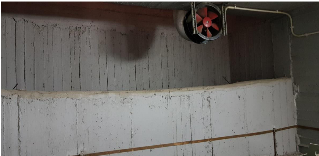
Εικόνα 72. Ειδική κατασκευή για την περισυλλογή των υδάτων που εισέρχονται από την αεροθρυρίδα του Υ/Σ που βρίσκεται ακριβώς από πάνω. Στη βάση της έχει χώμα για την απορρόφηση των υδάτων, Πηγή: Προσωπικό Αρχείο
