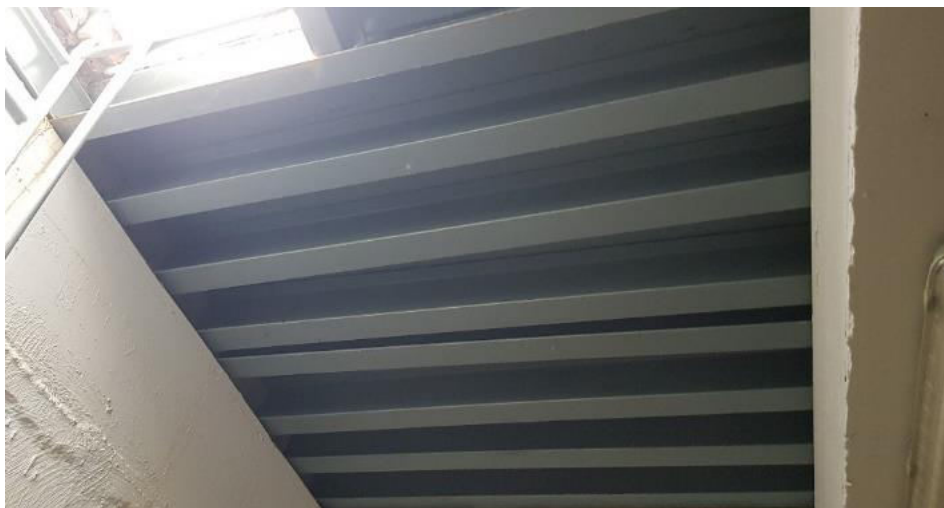
Εικόνα 81. Καταπακτή εισόδου – εξόδου μηχανημάτων του Υ/Σ με κοιλοδοκούς, Πηγή: Προσωπικό Αρχείο
