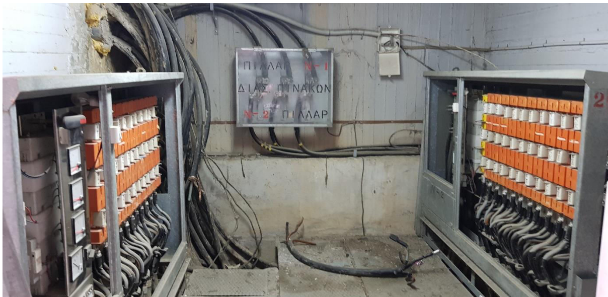
Εικόνα 65. Διασύνδεση Πινάκων Χαμηλής Τάσης, Πηγή: Προσωπικό Αρχείο
