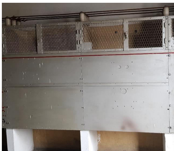
Εικόνα 23. Πίνακας Μέσης Τάσης – Εφεδρικές «καμπίνες», Πηγή: Προσωπικό Αρχείο
