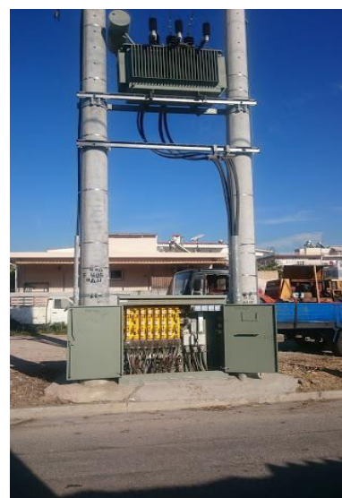
Εικόνα 4. Πίνακες Χαμηλής Τάσης (Πύλο) σε Εναέριους Υ/Σ Διανομής, Πηγή: Προσωπικό Αρχείο
