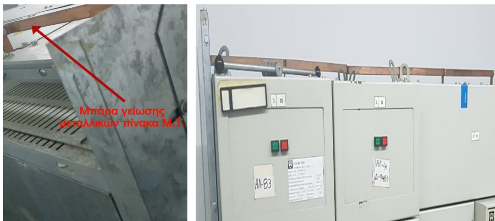
Εικόνα 133. Τα μεταλλικά μέρη των επιμέρους Μονάδων του Πίνακα Μ.Τ. γειώνονται μέσω της χάλκινης μπάρας στο πίσω μέρος του Πίνακα Μ.Τ., Πηγή: Προσωπικό Αρχείο
