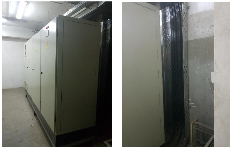
Εικόνα 145. Τα καλώδια Χ.Τ. των 400 Volt, φθάνουν από τον χώρο του Μ/Σ Ισχύος στον Γενικό Πίνακα Χαμηλής Τάσης του ΓΑΛΑΞΙΑ με τάξη, μέσω ειδικά διαμορφωμένων καναλιών, Πηγή: Προσωπικό Αρχείο
