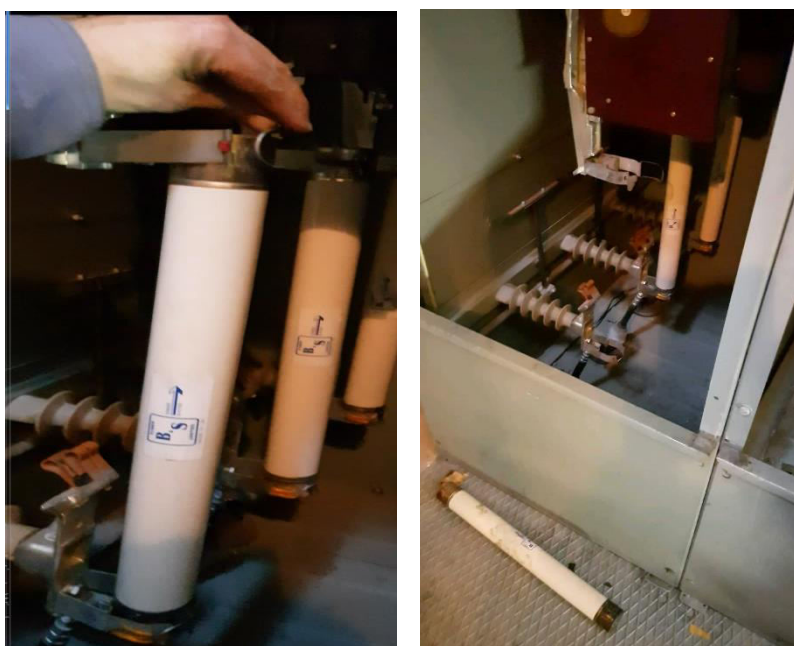
Εικόνα 114. Διαδικασία αντικατάστασης της σπασμένης βάσης στην οποία κουμπώνει η ασφάλεια Μέσης Τάσης τύπου Σκόνης της 3 ης φάσης, στην Μονάδα Προστασίας του Μ/Σ Ισχύος του Πίνακα Μέσης Τάσης. Η διαδικασία αφαίρεσης της ασφάλειας απαιτεί πολύ λεπτούς χειρισμούς, Πηγή: Προσωπικό Αρχείο
