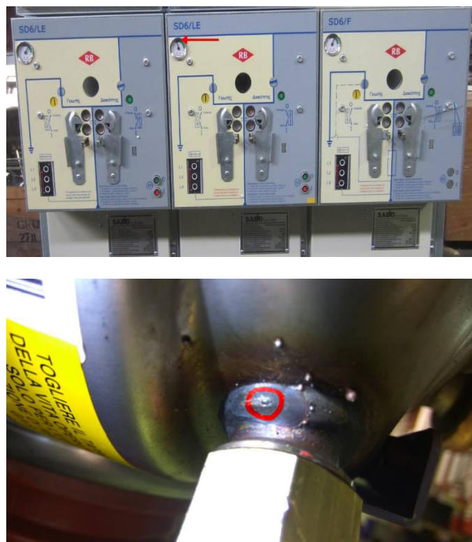
Εικόνα 90. Α. Απώλεια Αερίου SF6 στην μεσαία μονάδα του Πίνακα Μέσης Τάσης (Ένδειξη στην κόκκινη περιοχή του μανόμετρου) Β. Το Σημείο της απώλειας
