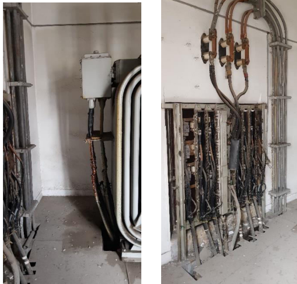
Εικόνα 26. Τα καλώδια της Χαμηλής Τάσης (Γενικά Καλώδια), ανεβαίνοντας στον τοίχο, μέσω των γενικών μαχαιριών καταλήγουν στον Πίνακα Χαμηλής Τάσης, Πηγή: Προσωπικό Αρχείο
