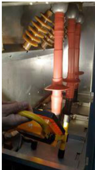
Εικόνα 131. Η Μονάδα Άφιξης του Υπογείου Καλωδίου Μ.Τ. πλήρως συντηρημένη, Πηγή: Προσωπικό Αρχείο
