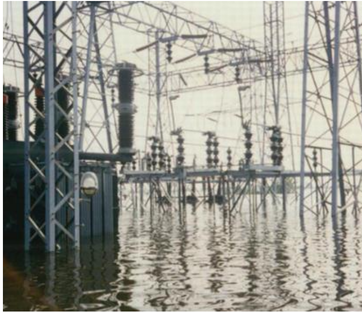
Εικόνα 2. Πλημμυρισμένοι υποσταθμοί ενέργειας κατά τη διάρκεια της πλημμύρας του ποταμού του Mississippi το 1993 [9]
