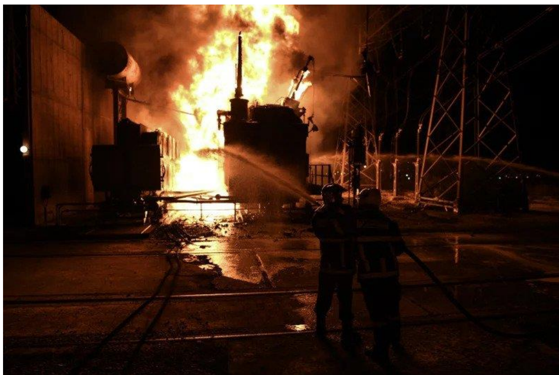
Εικόνα 10. Έκρηξη σε μετασχηματιστή του KYT Ασπροπύργου τον Ιανουάριο του 2021 [26]
