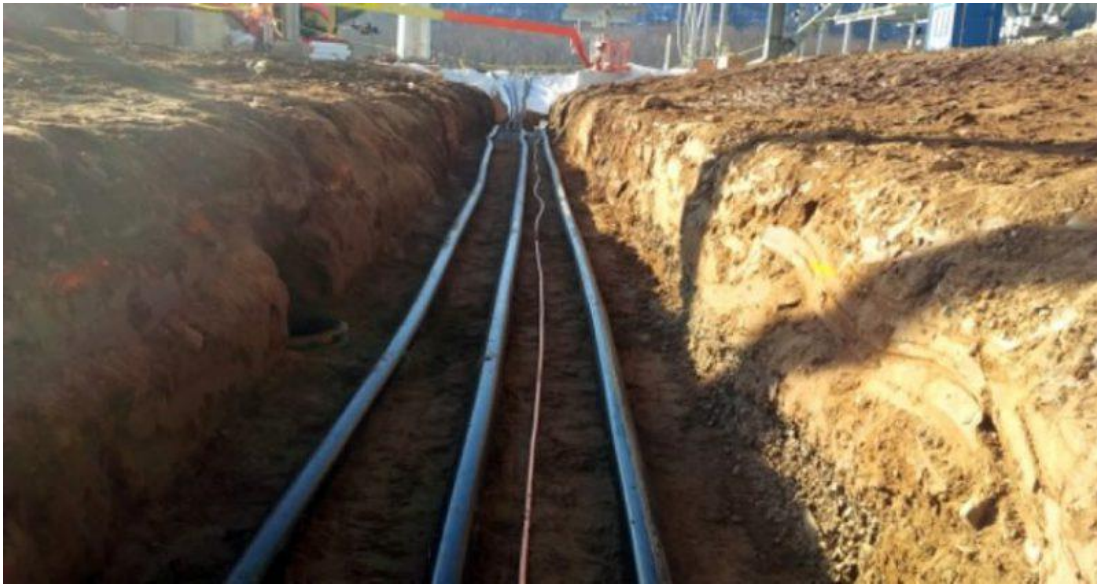
Εικόνα 6. Υπόγειες γραμμές ηλεκτρικής ενέργειας
