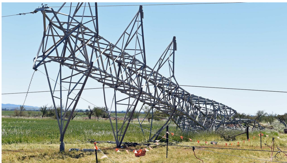
Εικόνα 4. Κατεστραμμένος πυλώνας μεταφοράς στην Αυστραλία. Σεπτέμβριος 2016
