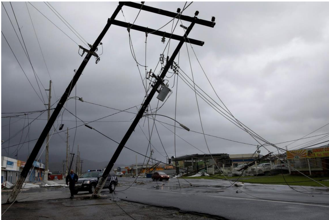
Εικόνα 1. Κατεστραμμένος πυλώνας διανομής ενέργειας στην περιοχή Guayama, Puerto Rico
