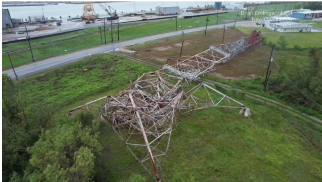
Εικόνα 2. Κατεστραμμένος πυλώνας μεταφοράς ενέργειας έξω από την πόλη της Νέας Ορλεάνης μετά τον τυφώνα "Ida"
