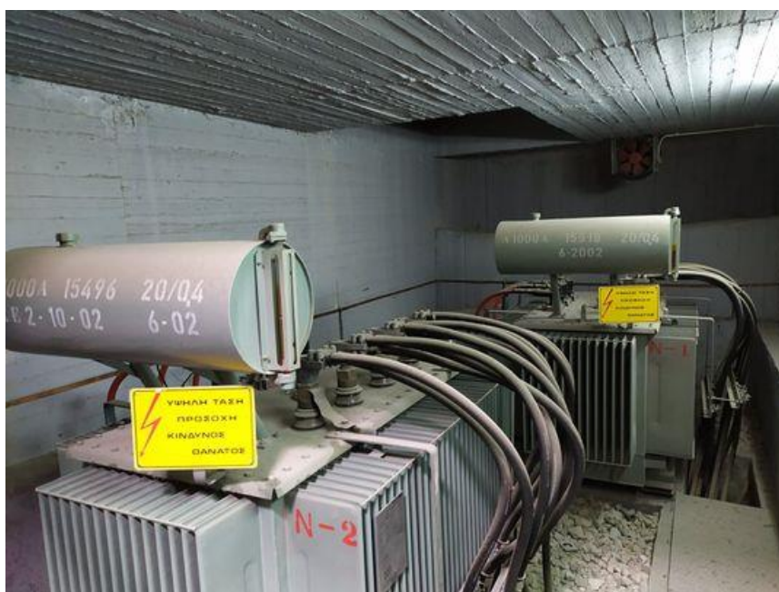
Εικόνα 98 Σημάνσεις αναγγελίας κινδύνου & Υψηλής Τάσης στον χώρο των Μ/Σ
