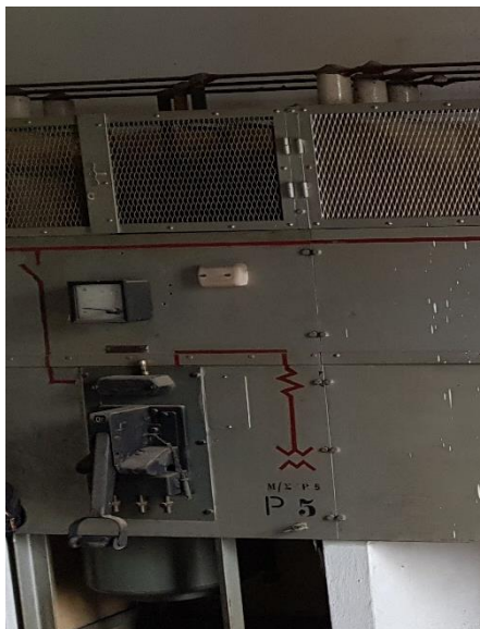
Εικόνα 66 Μονάδα Πίνακα Μέσης Τάσης προς Μ/Σ – Διακόπτης Ισχύος
