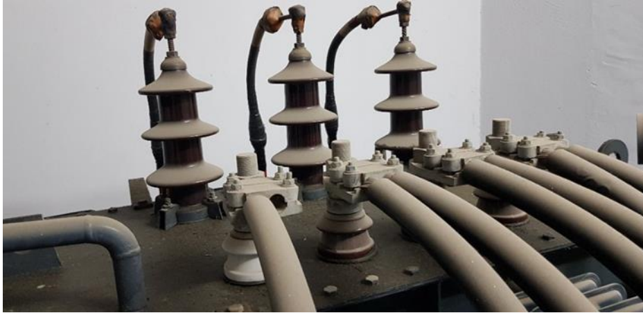
Εικόνα 91 Οι ακροδέκτες Χαμηλής Τάσης (μπροστά, με τους μικρούς μονωτήρες) & Μέσης Τάσης (στο βάθος με τους μεγάλους μονωτήρες)
