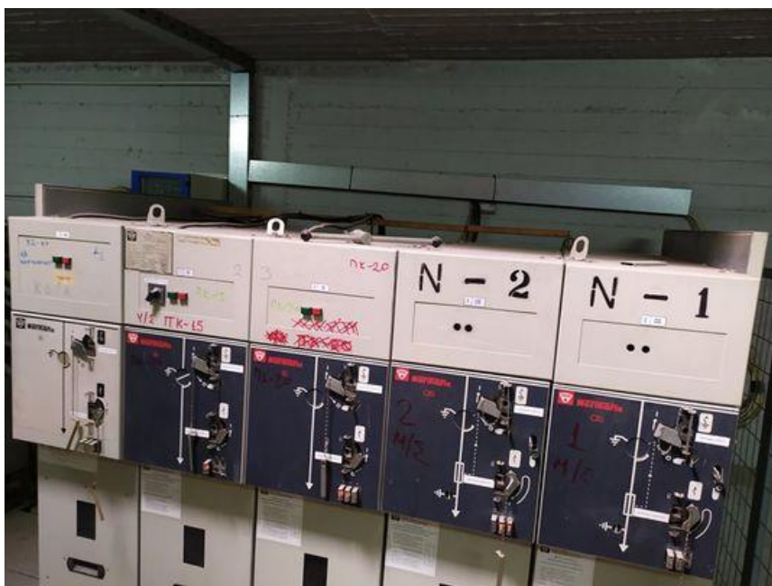
Εικόνα 99 Σύγχρονος Πίνακας Μέσης Τάσης με Διακόπτες Φορτίου με μόνωση SF6
