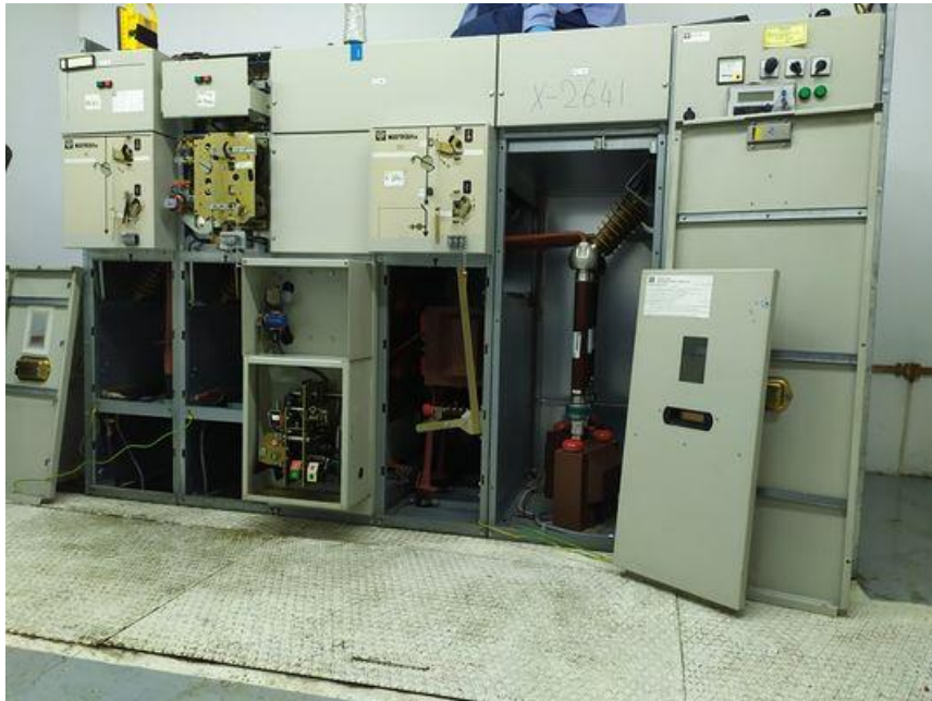
Εικόνα 113 Ανοιχτός Πίνακας ΔΕΔΔΗΕ
