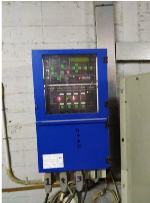
Εικόνα 100 Μονάδα RTU ( Remote Terminal Unit) για τηλεχειρισμούς
