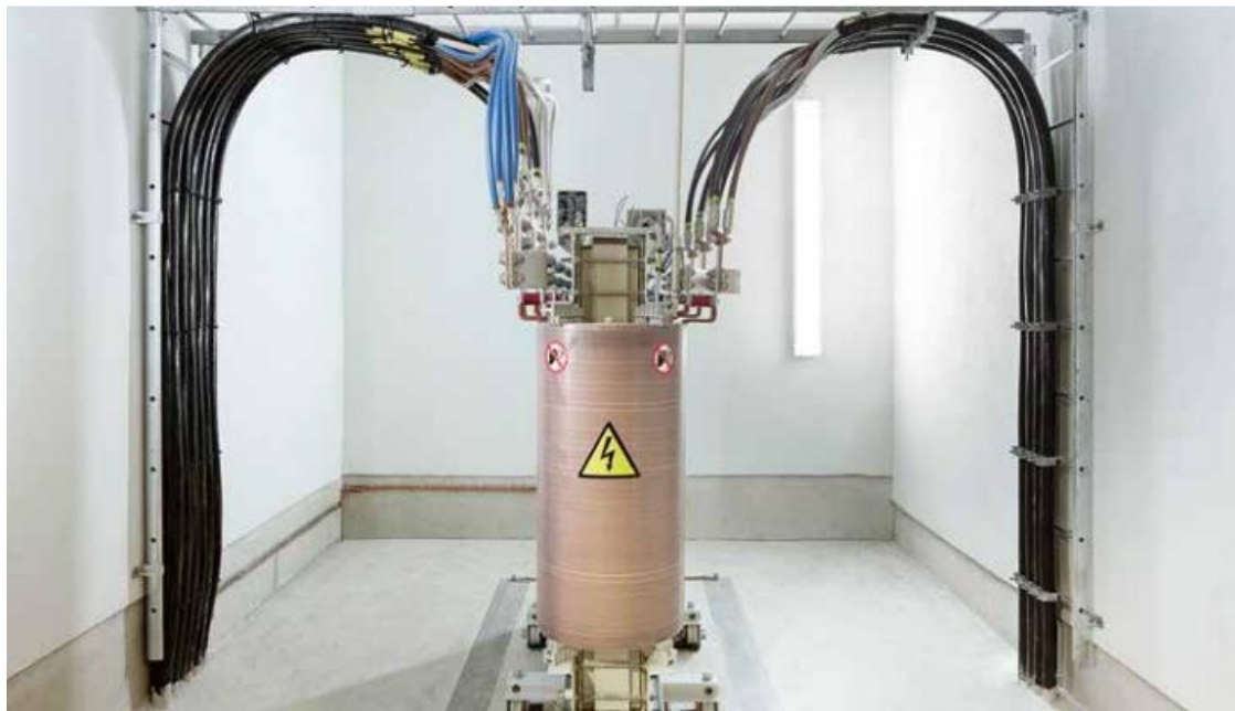
Εικόνα 18 Τριφασικός Μετασχηματιστής (ABB)
