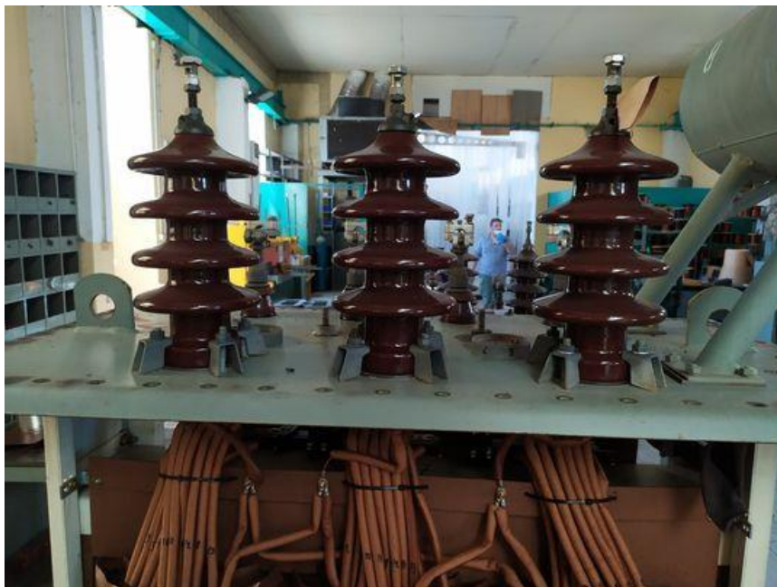
Εικόνα 32 Ακροδέκτες Υψηλής Τάσης
