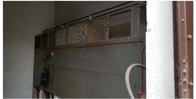
Εικόνα 65 Οι πρώτοι Πίνακες Μέσης Τάσης
