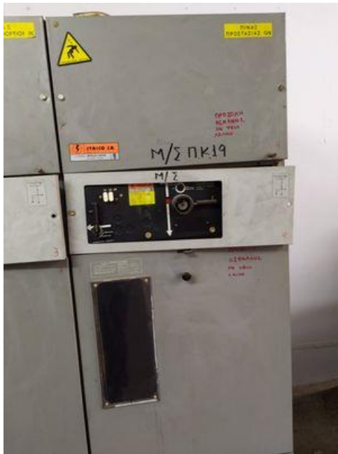
Εικόνα 87 Οι Επιμέρους μονάδες του Πίνακα Μέσης Τάσης του Υ/Σ Πόλεως ΠΚ-19
