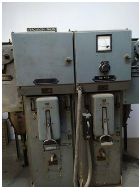
Εικόνα 75 Διακόπτες Ελαίου ( αριστερά ο Διακόπτης φορτίου στην μονάδα προς τον Υ/Σ ΠΒ-24 & δεξιά ο Διακόπτης Ισχύος με τη χαρακτηριστική φύσα, στην μονάδα προς Μ/Σ)
