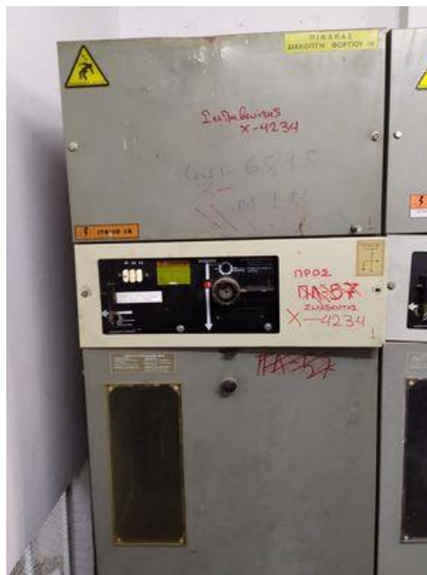
Εικόνα 85 Οι Επιμέρους μονάδες του Πίνακα Μέσης Τάσης του Υ/Σ Πόλεως ΠΚ-19
