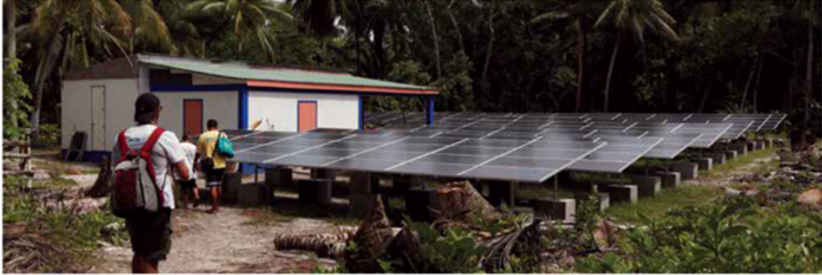
Εικόνα 3-9: Επιθεώρηση ενός ηλιακού μίνι δικτύου στο Mog Mog, Πολιτεία Υαρ
