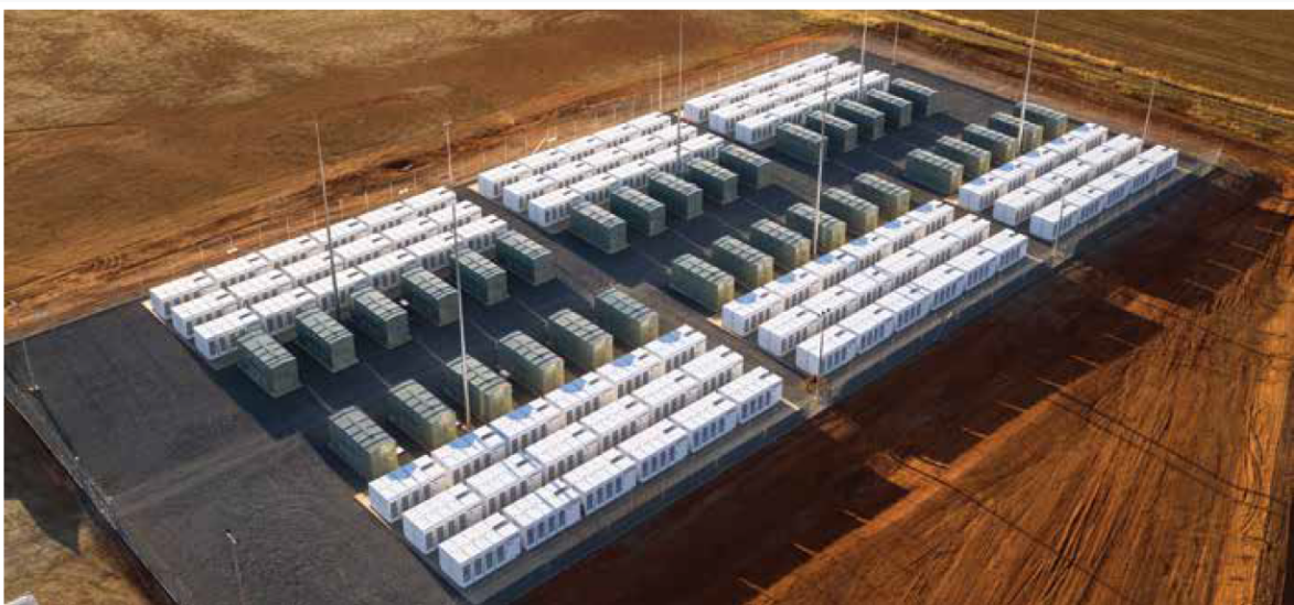
Εικόνα 3-2: Το έργο Hornsdale power reserve στη Νότια Αυστραλία
